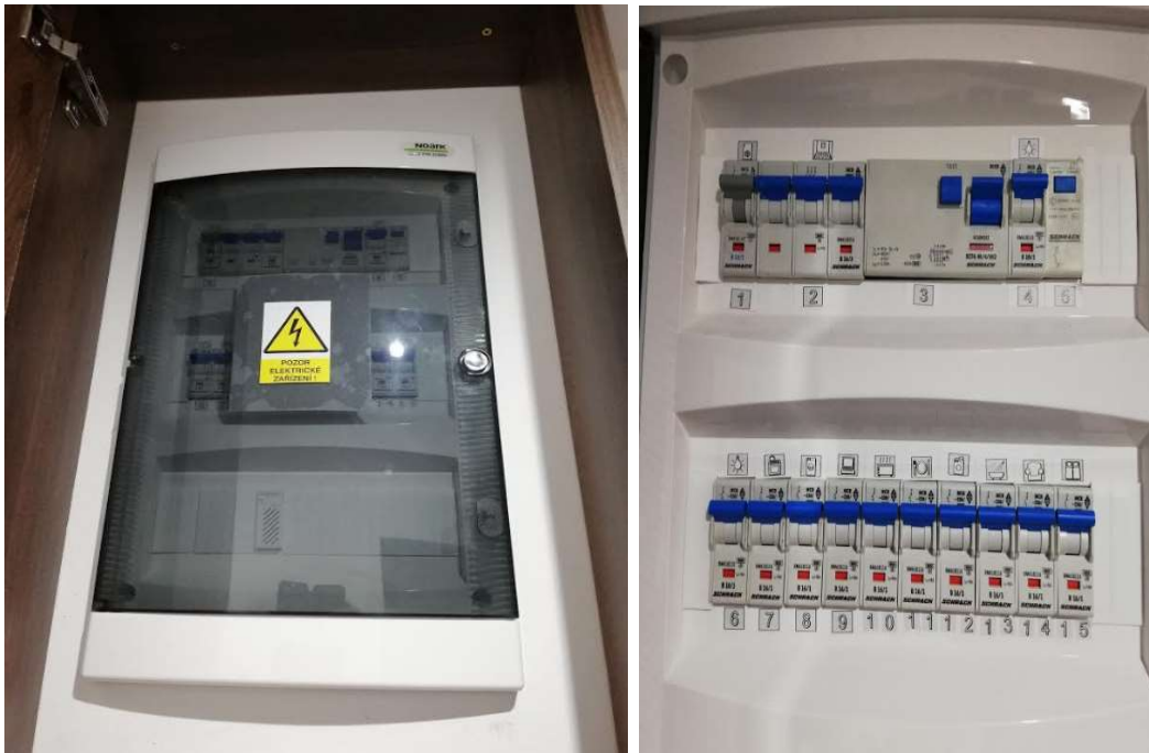
Obr. 36-37: Nový bytový rozvaděč
