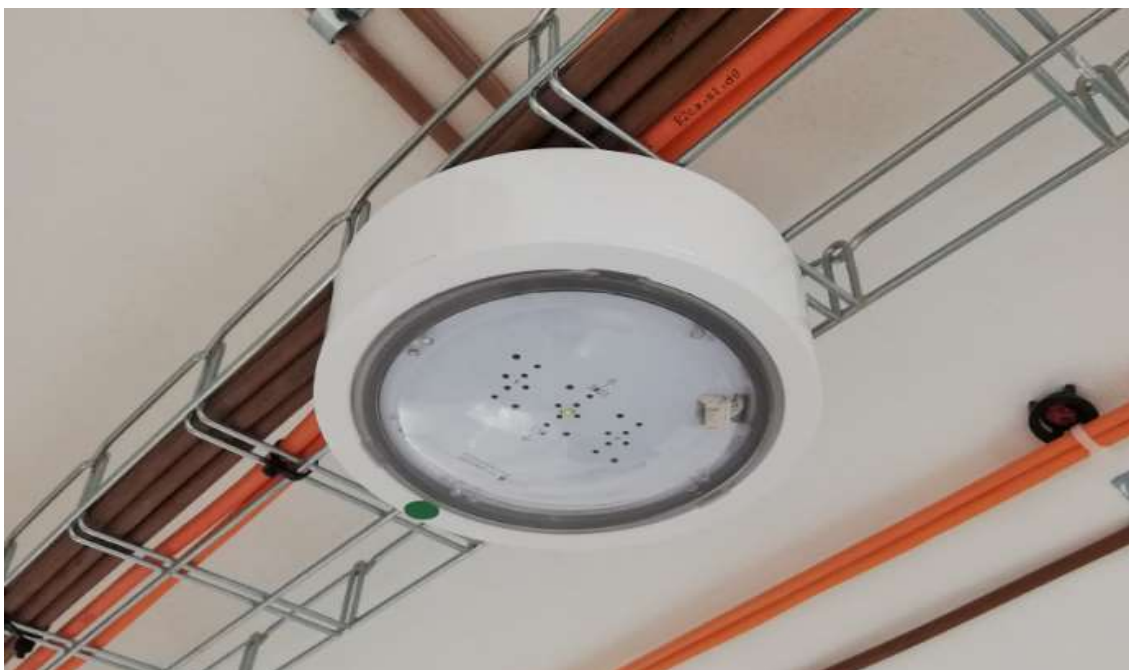
Obr. 25: Detail nouzového osvětlení
