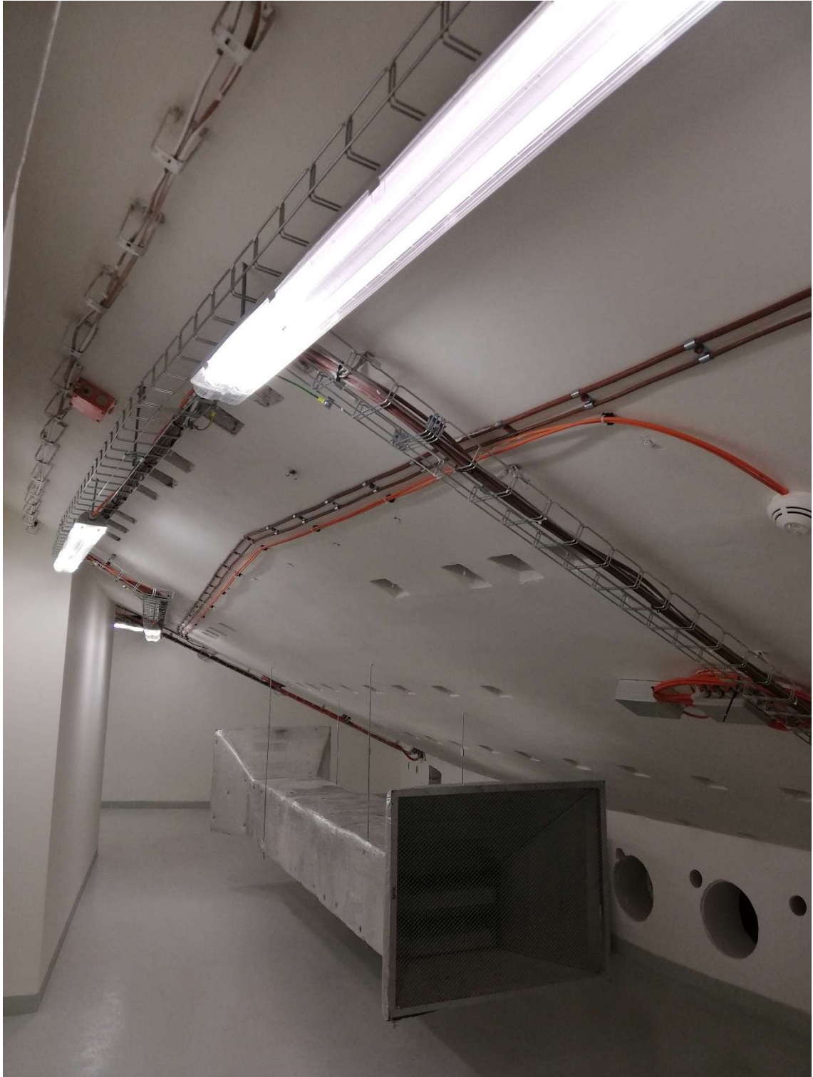
Obr. 24: Fotografie rozvodny vzduchotechniky
