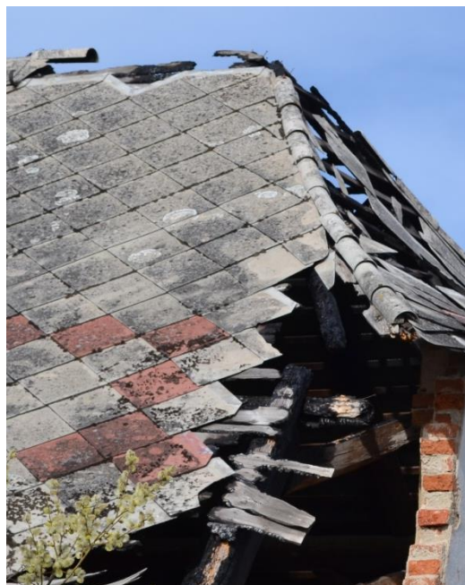
Obrázek č. 32 Azbestocementové desky
