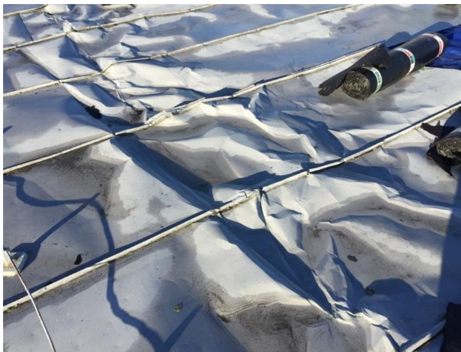
Obr. 3: Zdeformovaná původní střešní krytina zdroj: vlastní fotografie
