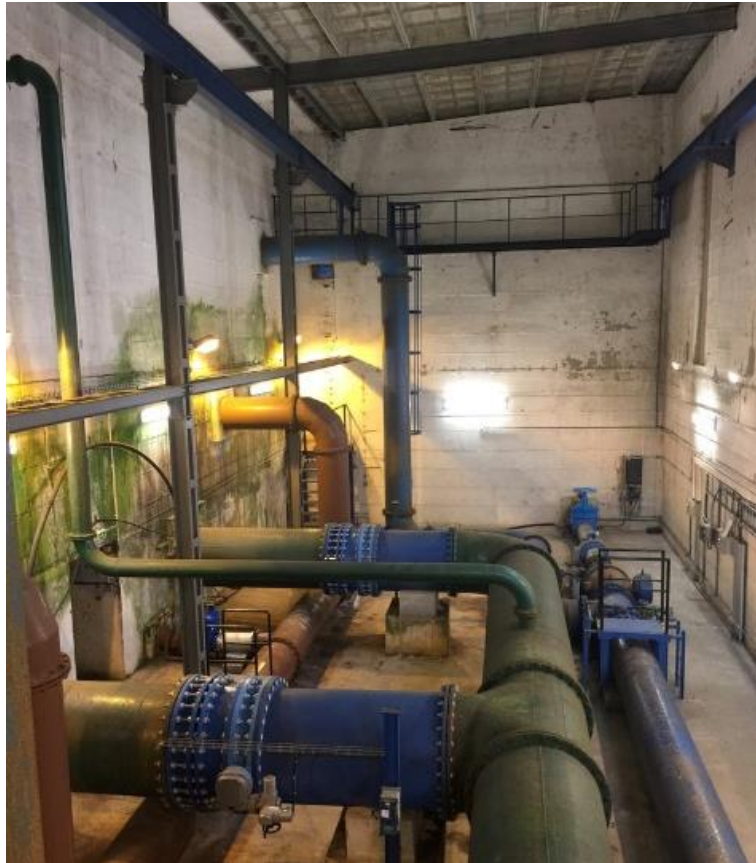
Obr. 5: Pohled do manipulační komory zdroj: vlastní fotografie
