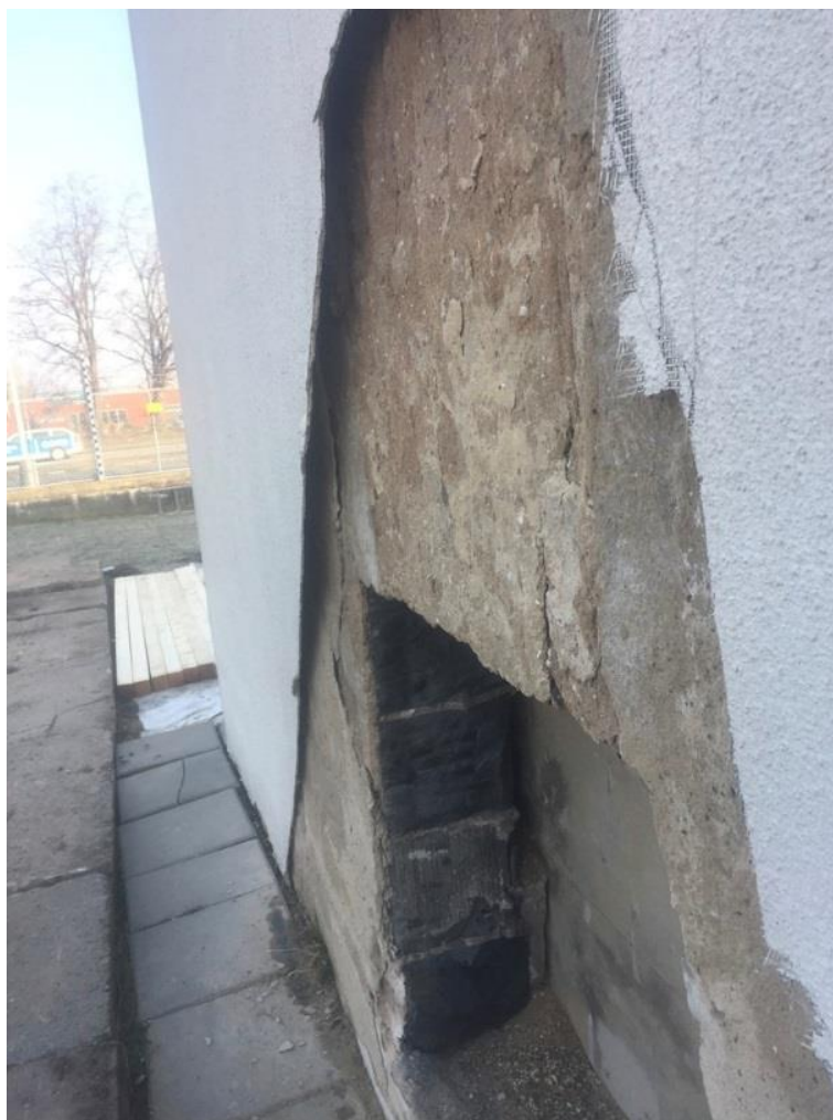
Obr. 4: Původní stav poničené fasády zdroj: vlastní fotografie
