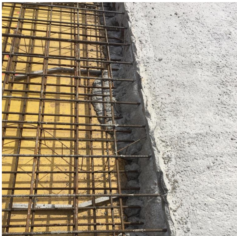
Obr. 23: Pracovní spára při betonáži stropu zdroj: vlastní fotografie
