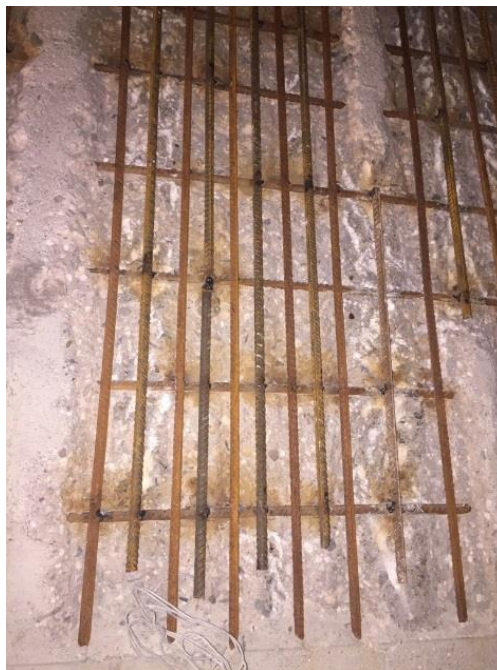
Obr. 8: Odkrytá výztuž stěny zdroj: vlastní fotografie
