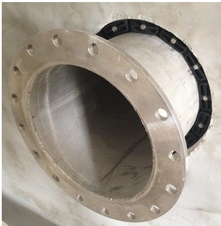
Obr. 32: Těsnicí řetězy na potrubí zdroj: vlastní fotografie
