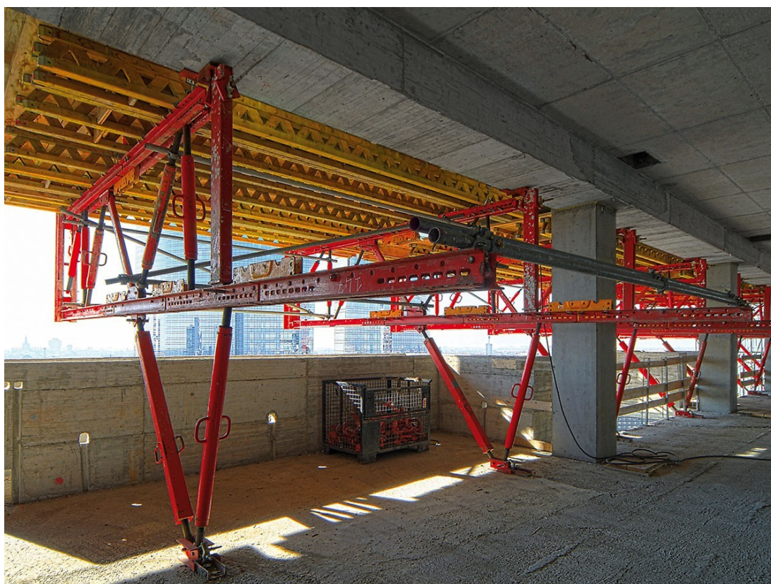
Obrázek 20 - obvodový průvlak napojený na sloupy
