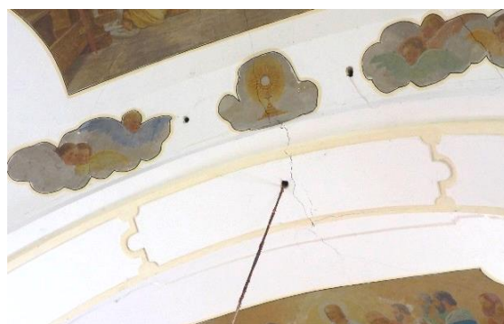
Obr.065 Prasklina ve klenebním pasu
