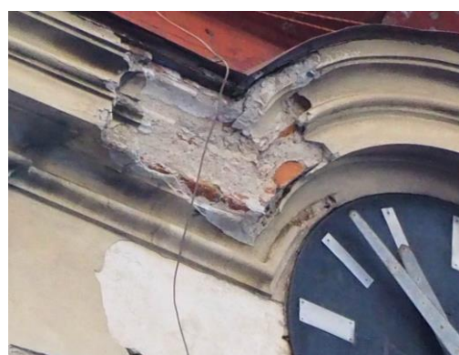
Obr.089 Porušení jižní niky
