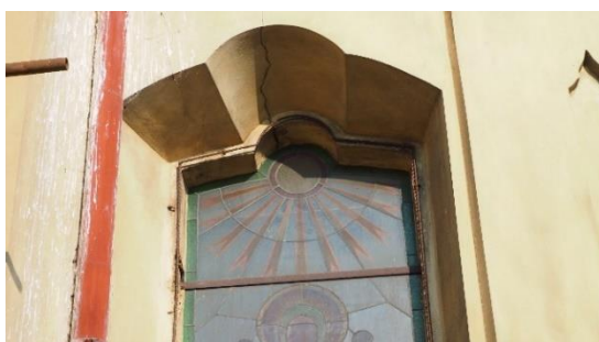
Obr.048 Prasklina v nadpraží, jižní strana lodi
