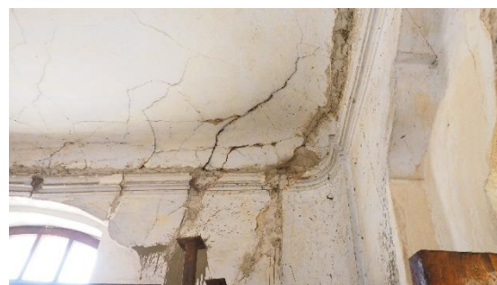
Obr.093 Porušení u stěny s oknem
