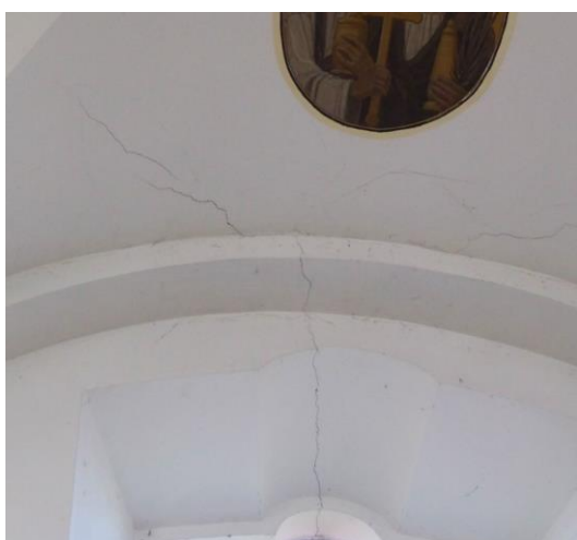
Obr.066 Trhlina vycházející z nároží
