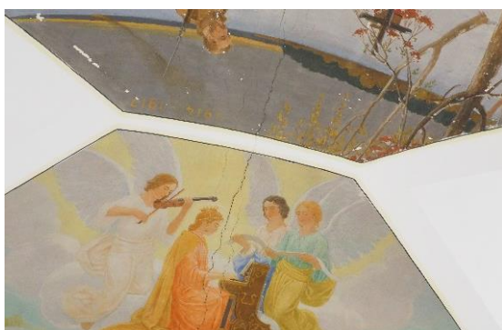
Obr.064 Kontinuální trhlina procházející lodí
