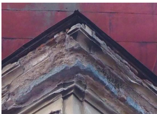
Obr.088 Porušení severní niky
