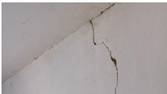
Obr.090 Roh porušené barokní márnice
