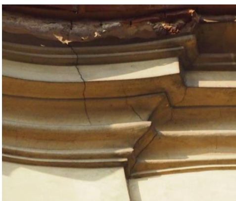
Obr.087 Porušení jižní niky
