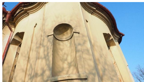
Obr.083 Porušení jižní niky
