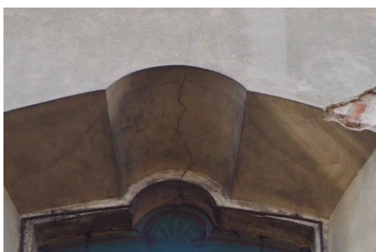
Obr.050 Prasklina v nadpraží, sever sv. Anežka
