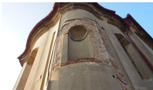
Obr.082 Porušení severní niky
