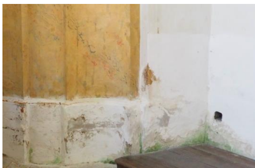
Obr.052 Zvýšená vlhkost presbytáře interiér
