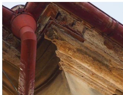
Obr.085 Porušení jižní niky
