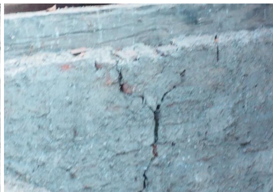
Obr.071 Trhliny v severní zídce
