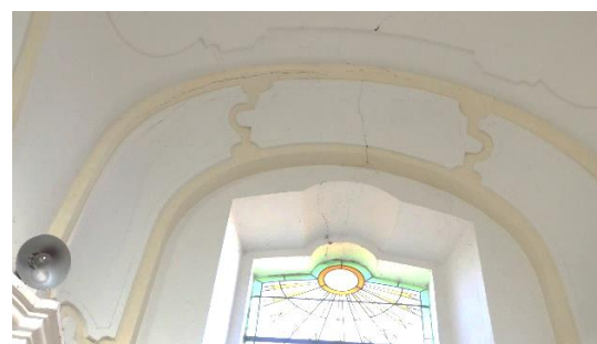
Obr.049 Prasklina v nadpraží, jižní strana lodi
