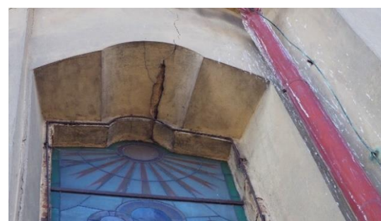
Obr.047 Prasklina v nadpraží, severní strana lodi
