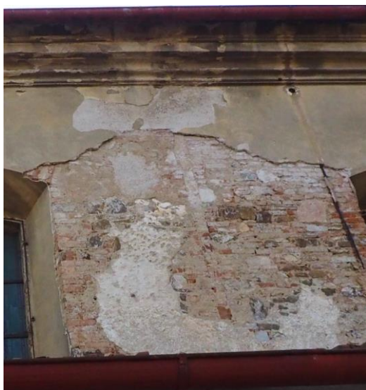
Obr.058 Poškození soklové části u sakristie
