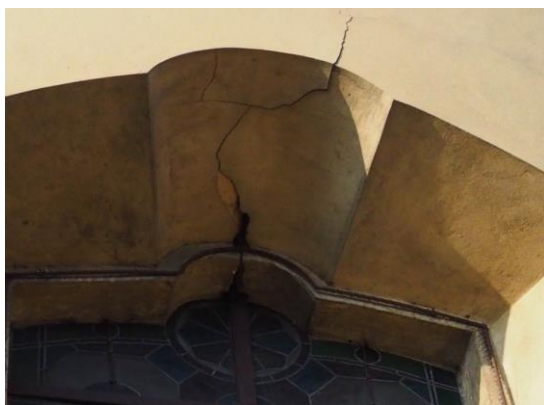
Obr.044 Prasklina v nadpraží, presbytář exteriér
