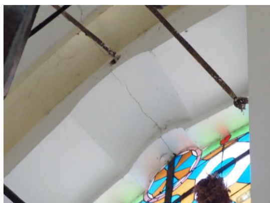
Obr.045 Prasklina v nadpraží, presbytář interiér
