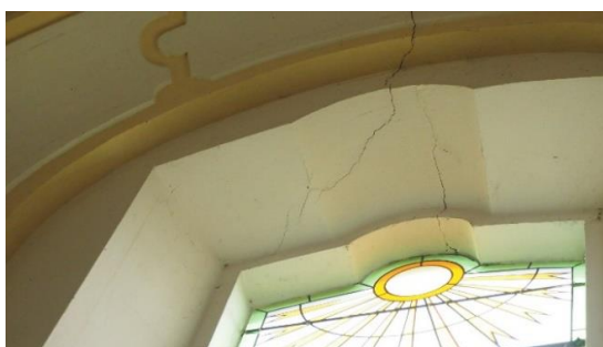
Obr.046 Prasklina v nadpraží, severní strana lodi
