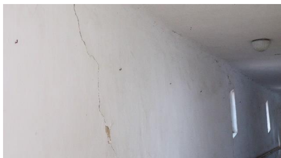
Obr.091 Porušení u stěny s oknem
