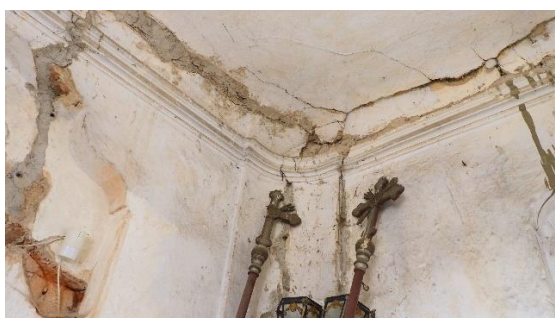
Obr.092 Roh porušené barokní márnice
