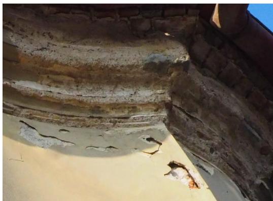
Obr.084 Porušení severní niky
