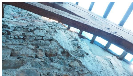
Obr.018 Vodorovná dělicí spára a otisk původního sklonu
