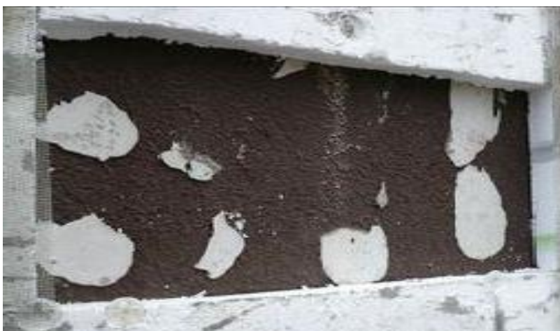
Obrázek 40 - Nepovolené lepení tepelného izolantu na buchtý
