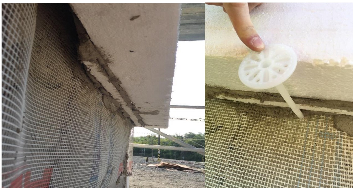
Obrázek 35 - Nepovolené vyrovnání podkladu izolačním materiálem a následné nesplnění potřebné kotevní délky
