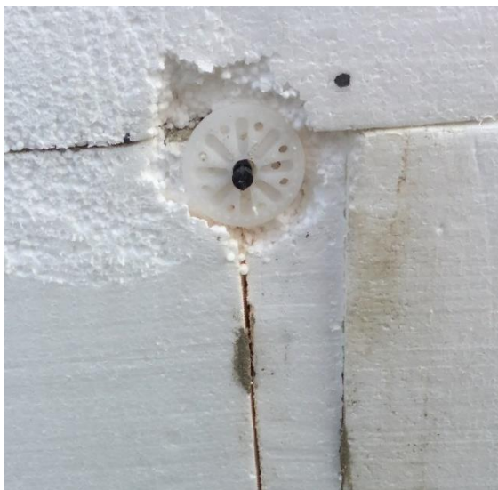
Obrázek 47 - Nedostatečně zapuštěný trn kotvy a příliš zapuštěná hmoždinka
