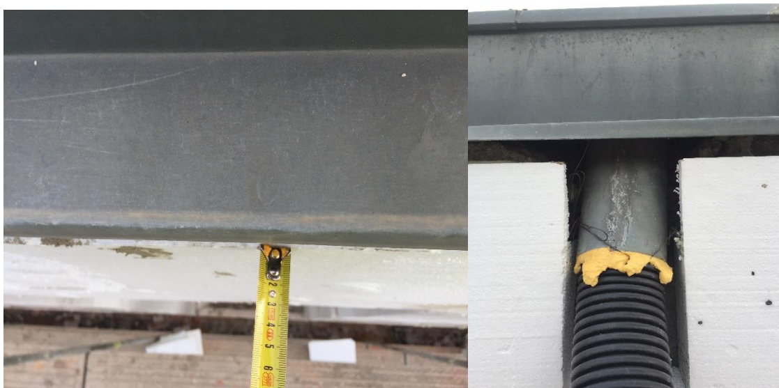
Obrázek 32 - Nevyhovující připravenost klempířských prvků pro systém ETICS
