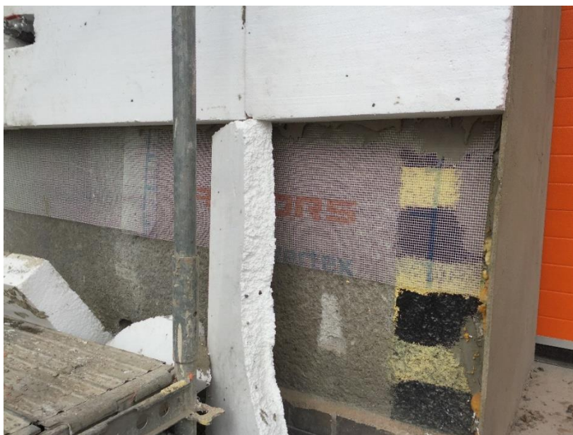
Obrázek 37 - Chybné založení systému ETICS pomocí odřezků izolačních desek
