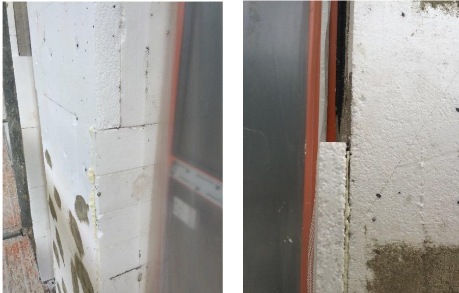
Obrázek 43 - Chyba v provedení zateplení špalet oken
