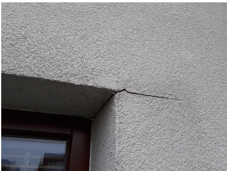
Obrázek 51 - Trhlina v rohu okna z důvodu nevyztužení diagonály
