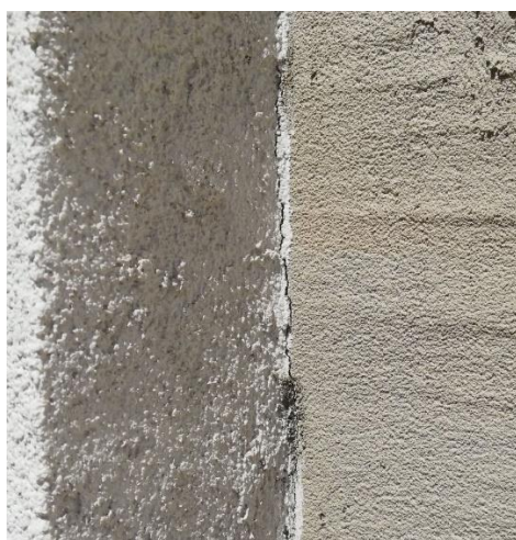
Obrázek 50 - Trhlina v místě dilatace dvou budov
