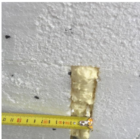
Obrázek 44 - Nadměrně velká mezera mezi deskami pro použití PUR pěny
