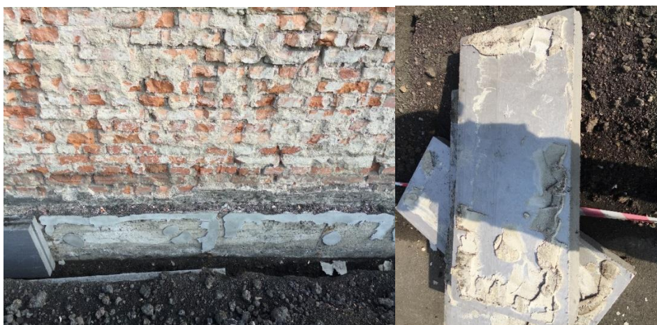
Obrázek 39 - Nevhodné zvolení izolantu XPS, lepidla a nedodržení lepicí plochy
