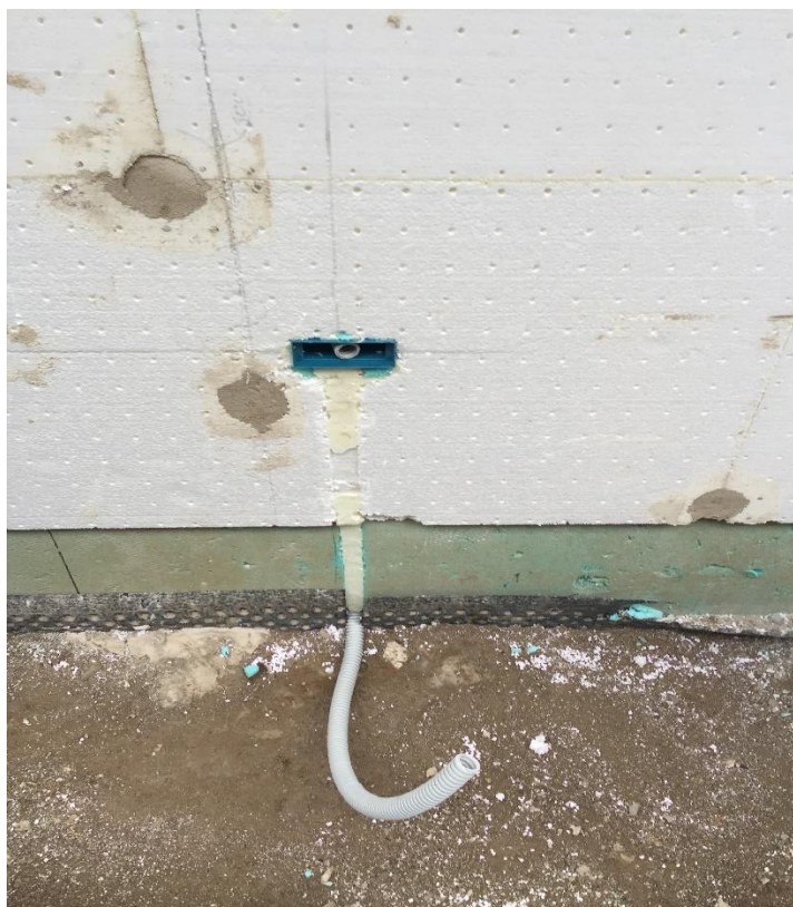
Obrázek 38 - Nedostatečná výška založení
