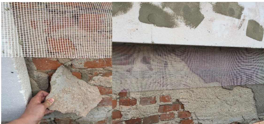
Obrázek 34 - Nevyhovující rovinnost a soudržnost podkladu
