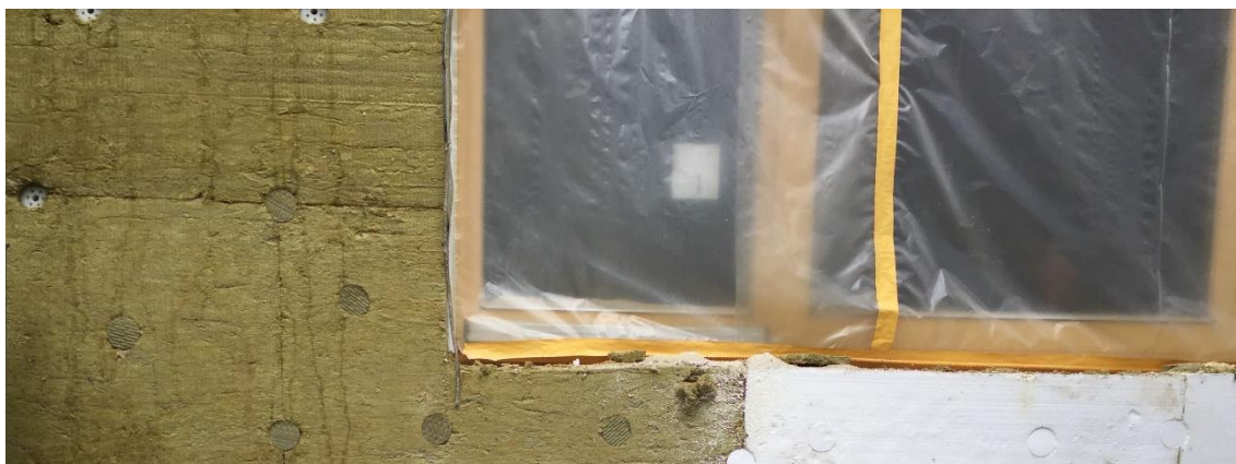
Obrázek 46 - Nezakryté veškeré kotvy fasádními víčky
