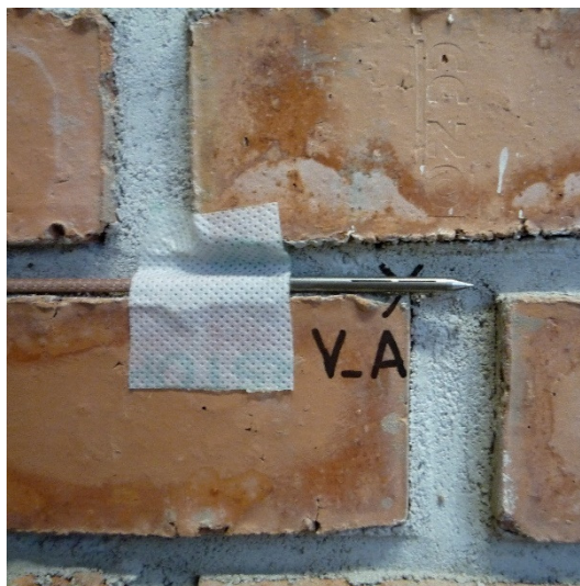
Obrázek 16 - Čidlo pro měření teploty a relativní vlhkosti na rozhraní mezi izolací a zdivem u skladby S3 [10]
