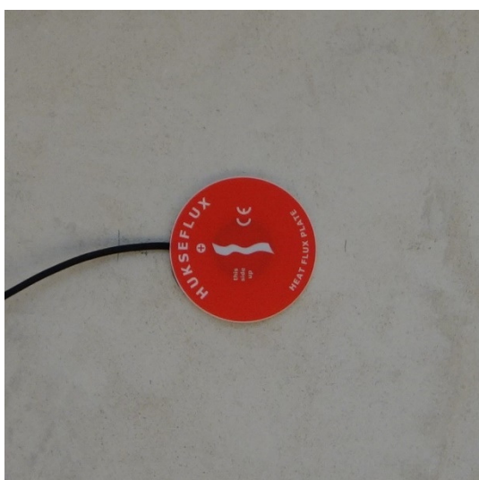
Obrázek 17 - Čidlo pro měření hustoty tepelného toku u skladby S1a [10]
