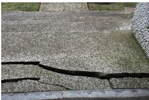
Obr. 32 Detail popraskaného schodišťového stupně hlavního exteriérového schodiště
