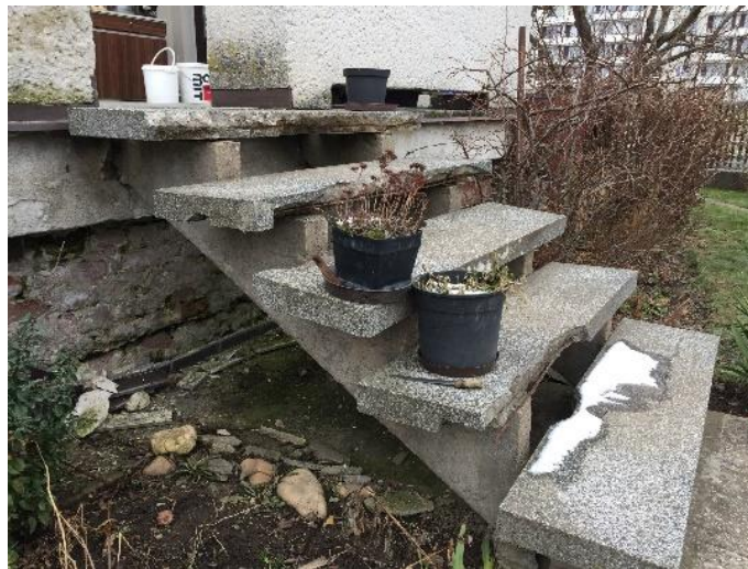
Obr. 34 Zdevastované schodiště na venkovní terasu
