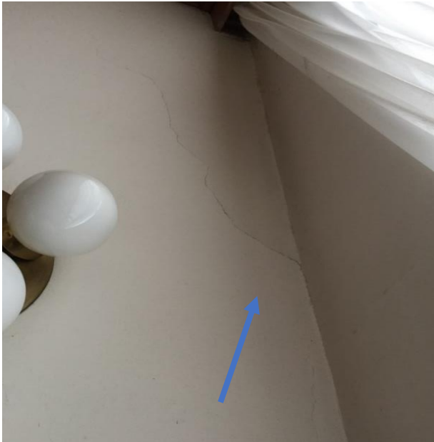
Obr. 14 Větvená trhlina mezi stykem dvou konstrukcí
