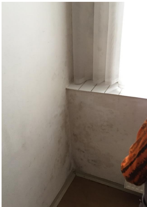
Obr. 19 Plesnivějící stěna na mezipodestě suterénního schodiště
