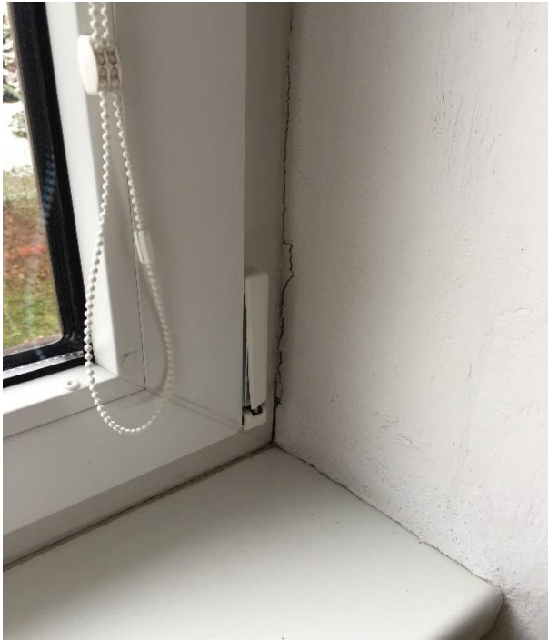
Obr. 28 Praskliny u parapetu plastového okna v ložnici v 1. NP
