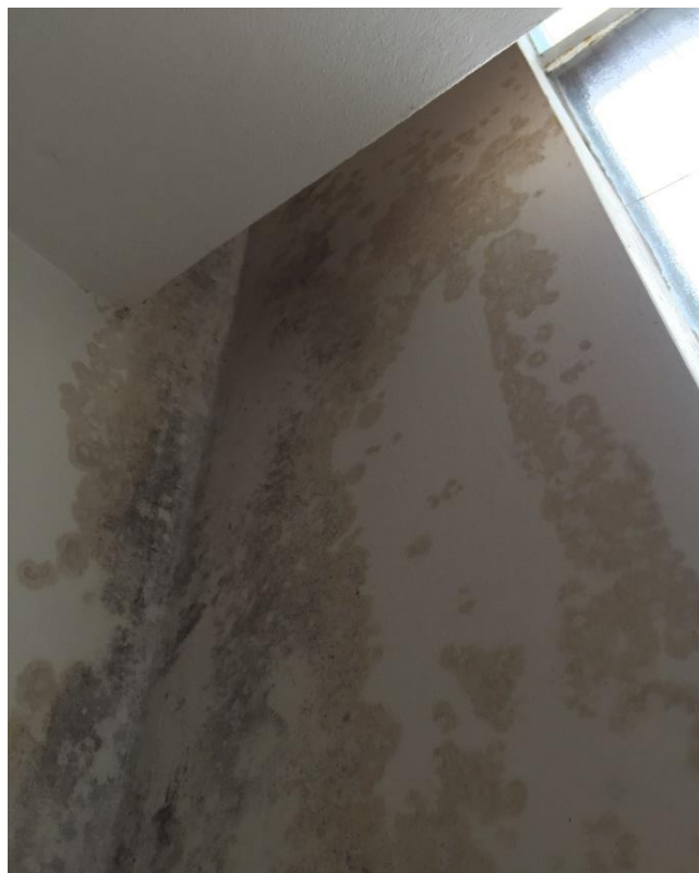
Obr. 20 Detail masivního výskytu plísní rozlézající se až k podestě 1. NP
