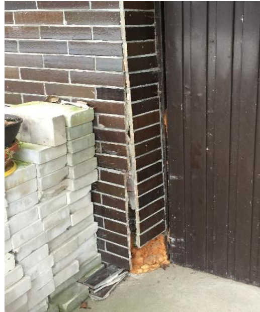
Obr. 15 Poškozené zdivo s obkladem u vjezdu do garáže a jeho dočasná oprava PUR pěnou
