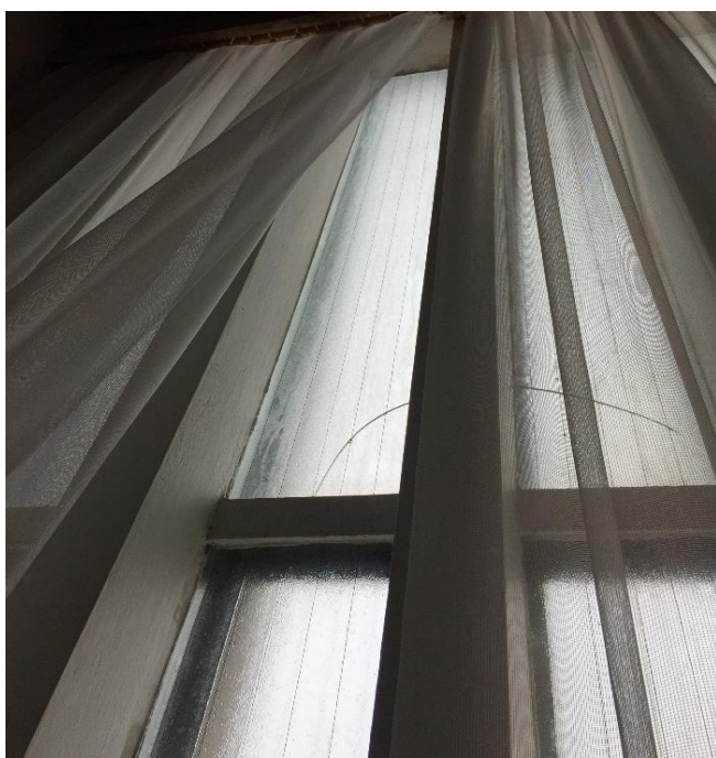
Obr. 26 Prasklé tabulky profilového skla na schodišti
