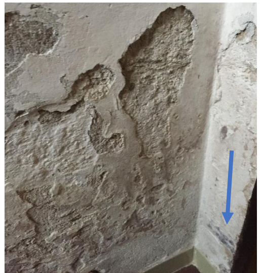
Obr. 18 Detail opadané vrchní části omítky a počínající plísně
