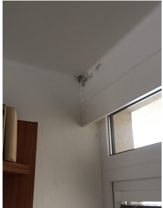
Obr. 22 Výskyt plísně na styku stropní konstrukce a obvodové stěny
