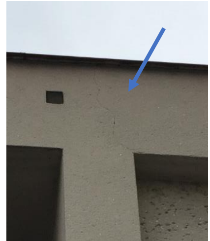
Obr. 25 Detail šikmé trhliny na atice
