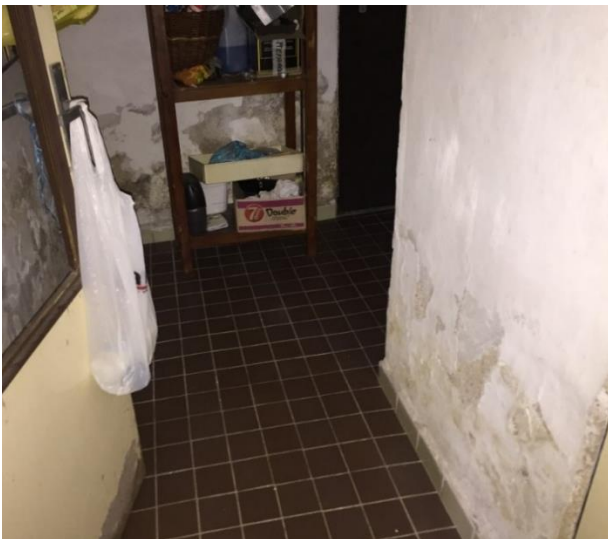
Obr. 17 Stav degradovaných omítek v chodbě 1. PP
