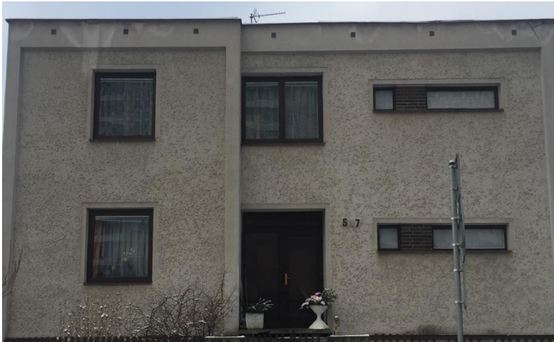
Obr. 24 Popraskaná atika na východní fasádě
