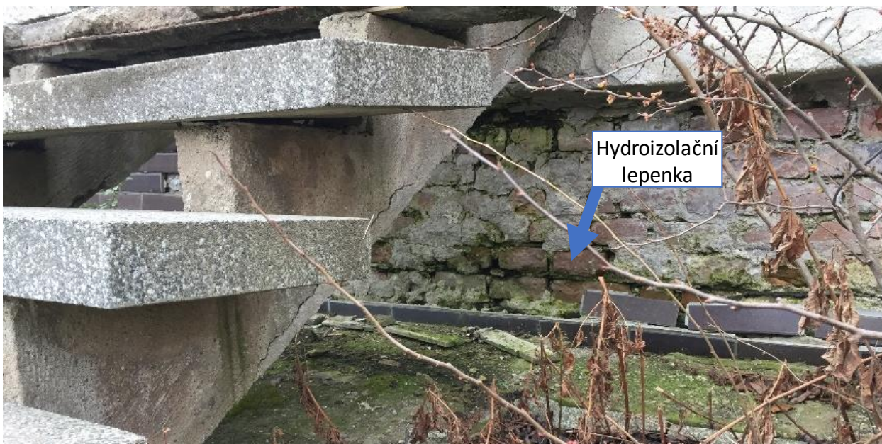
Obr. 37 Opadané kabřincové obkladačky a odhalené zdivo pod schody na terasu a viditelná linka hydroizolačního pásu
