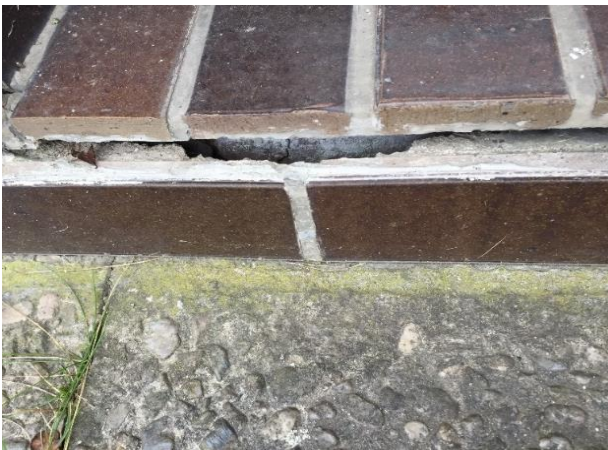
Obr. 16 Detail trhliny v kabřincovém obkladu v místě styku parapetu suterénního okna a okapového chodníku
