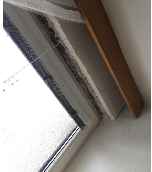
Obr. 29 Zplesnivělé nadpraží plastového okna a vnitřní zateplení v zimní zahradě
