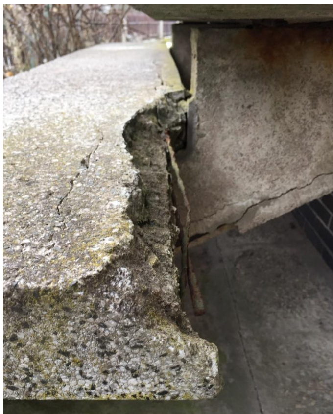
Obr. 31 Detail odroleného schodišťového stupně a schodnice s odhalenou ocelovou výztuží
