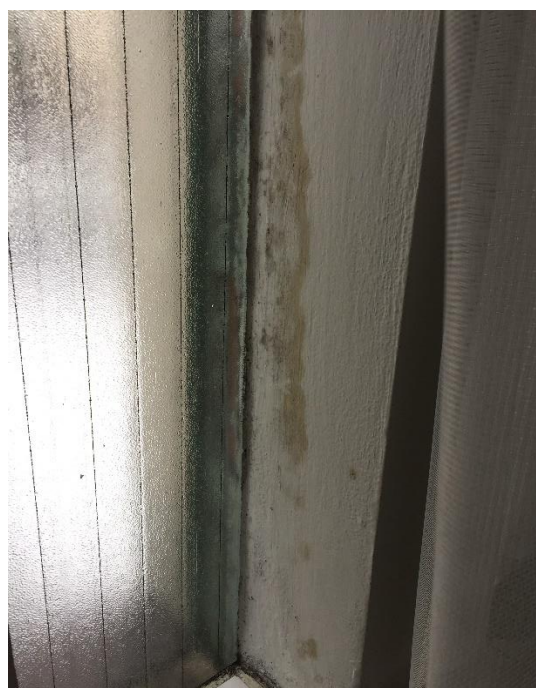
Obr. 27 Detail plísně tvořící se na ostění
