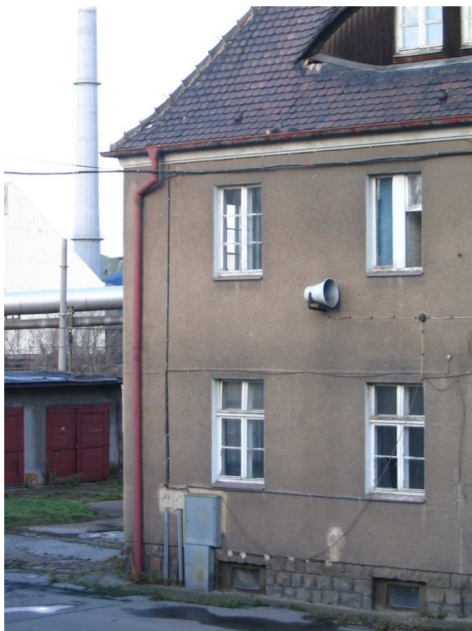
Obr. 8 : Stav před rekonstrukcí – budova A (zdroj: klempířská firma Riklepo)
