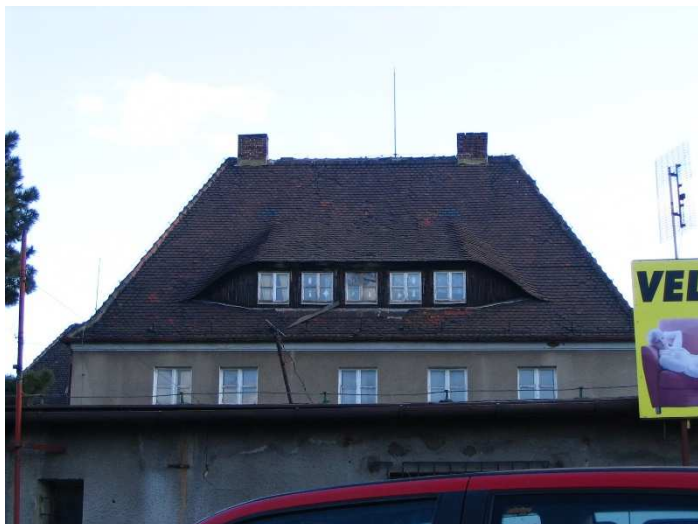
Obr. 6 : Stav před rekonstrukcí – budova A (zdroj: klempířská firma Riklepo)
