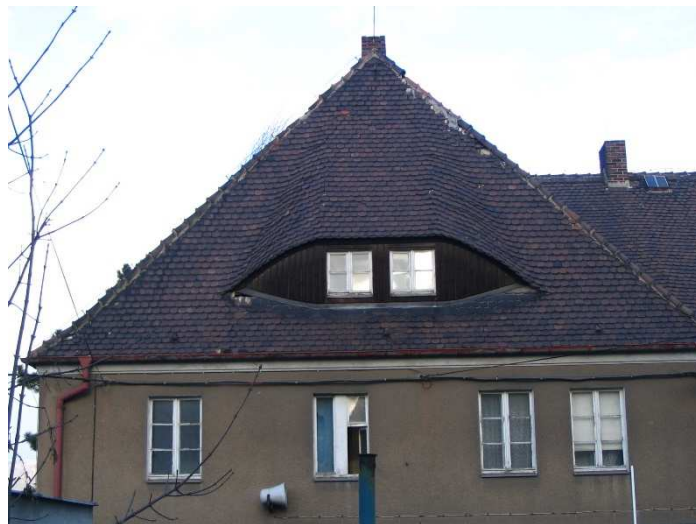
Obr. 7 : Stav před rekonstrukcí – budova A (zdroj: klempířská firma Riklepo)
