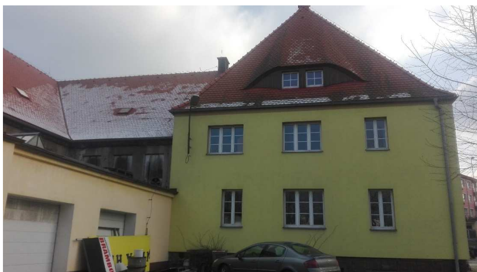
Obr. 11 : Současný stav – budova A, boční stěna (zdroj: vlastní foto)
