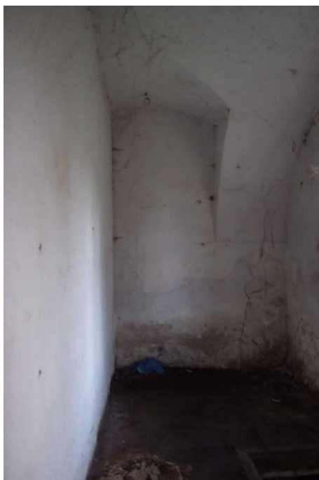
Foto F 2-71 - SZ stěna, trhliny
