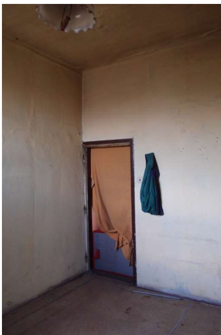
Foto F 3-38 Pohled na J roh m. 2.22
