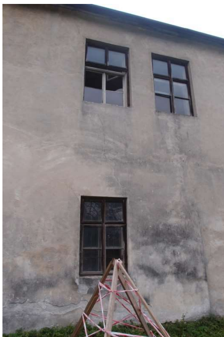
Foto F 1-9 - Detailní pohled v místě probíhající trhliny na SV fasádě
