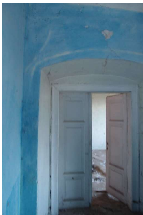
Foto F 3-51 - SZ stěna m. 2.27, trhlina
