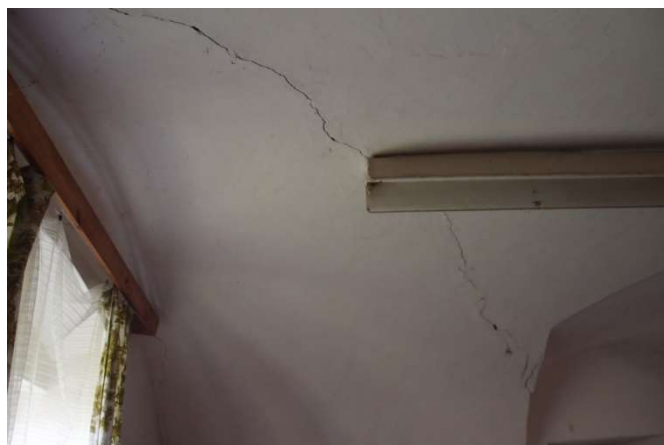
Foto F 2-53 - Detail trhliny klenby při V rohu místnosti 1.16
