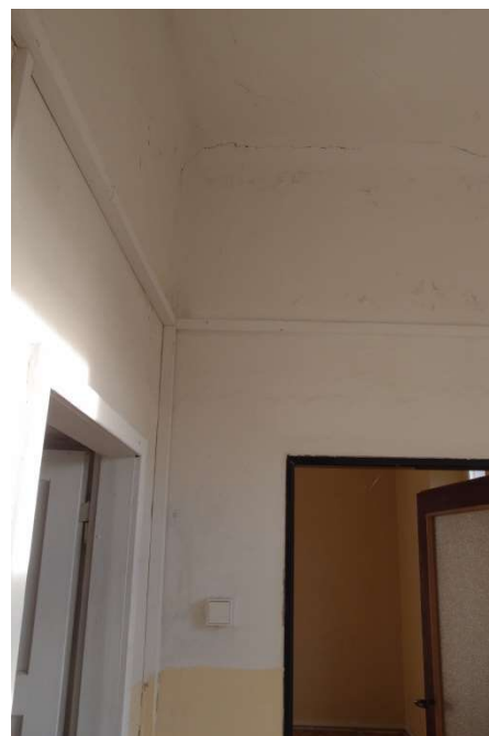
Foto F 3-62 - V roh m. 2.30, trhlina fabionu
