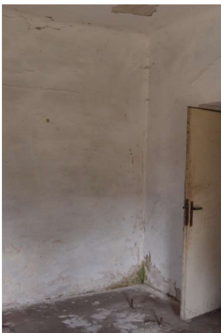
Foto F 2-12 - Pohled na severní roh místnosti 1.04 - vlhkost a plíseň
