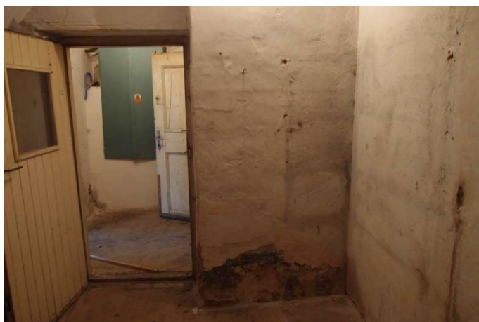
Foto F 2-28 - JV stěna mezi 1.08 a 1.09 - vlhkost, plíseň
