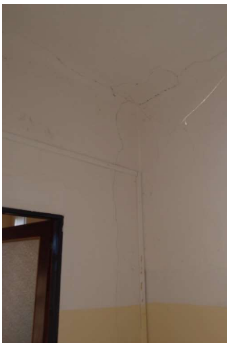
Foto F 3-61 - J roh m. 2.30, trhliny fabionu
