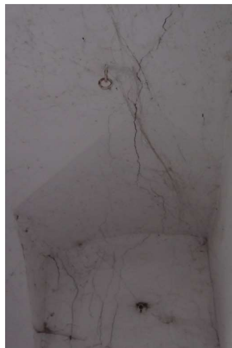
Foto F 2-73 - JV stěna, trhлина klenby
