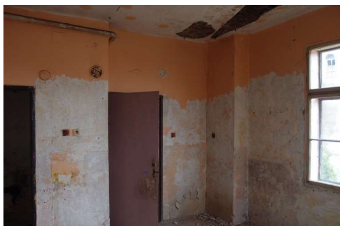
Foto F 3-13 - Pohled k V rohu od Z, poruchy v podhledu stropu m. 2.12
