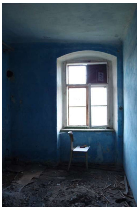
Foto F 3-52 - SV stěna m. 2.27
