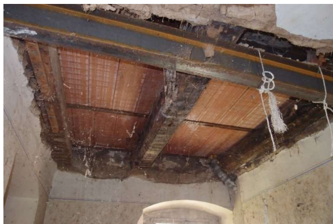
Foto F 2-84 - Obnažená nosná konstrukce stropu nad m. 1.23
