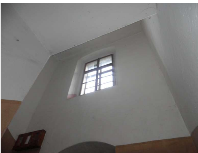
Foto F 2-63 - Schodišťový prostor - JZ stěna
