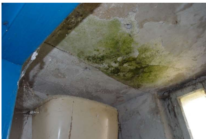
Foto F 2-36 - Plíseň pohledu WC místnosti 1.12
