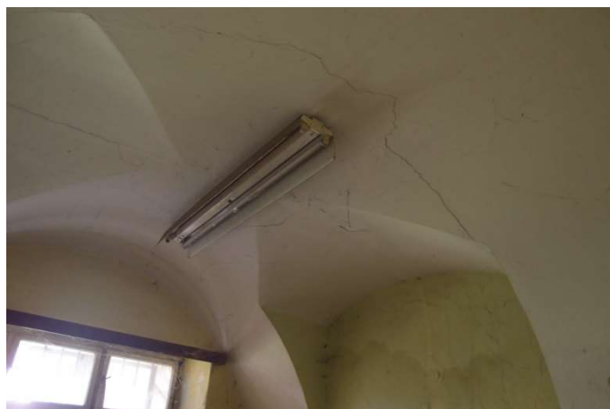
Foto F 2-58 - Soustava kleneb nad m. 1.17 - Střed místnosti, trhliny
