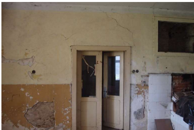
Foto F 2-77 - Pohled na SZ stěnu m. 1.22, dveře do m. 1.19, trhliny
