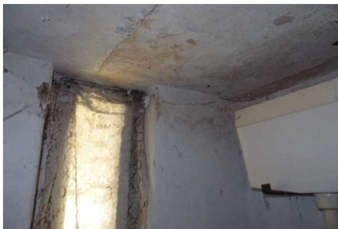
Foto F 2-40 - Trhliny kolem okna v SV obvodové stěně m. 1.13
