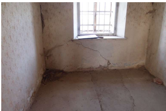
Foto F 2-81 - Pohled na SV stěnu, trhlina v parapetu okna
