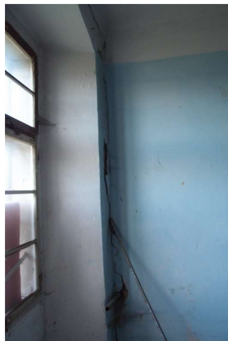
Foto F 3-59 - Trhlina ve V rohu m. 2.29
