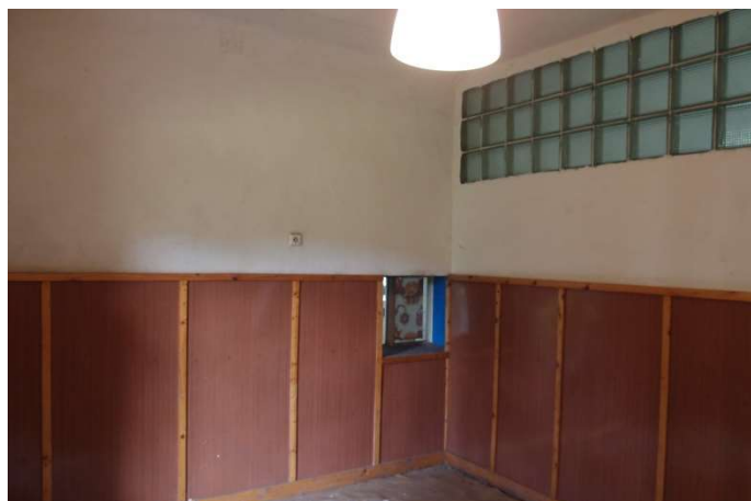
Foto F 2-47 - Pohled na S roh m. 1.15, okénko mezi 1.10 a 1.15
