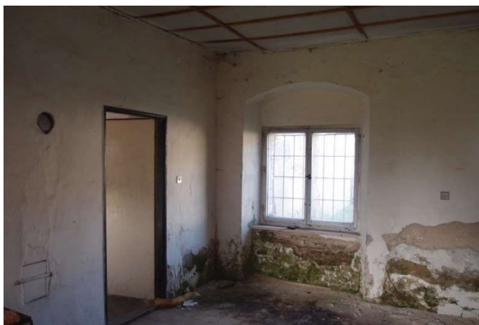
Foto F 2-14 - Pohled na Z roh místnosti 1.05 - vlhkost a plíseň
