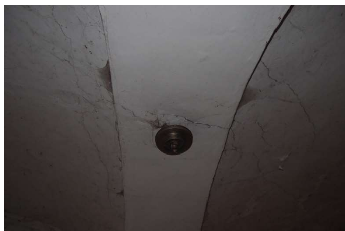
Foto F 2-68 - Trhlina ve vrcholu klenutého pžeklady
