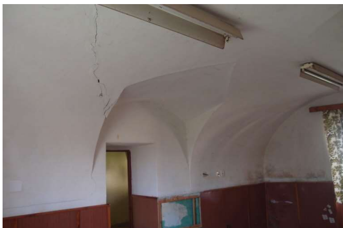
Foto F 2-52 - Pohled k J rohu, vstup do m. 1.17, trhlina klenby
