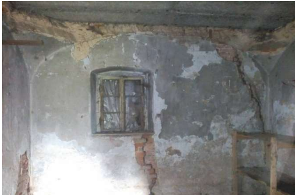
Obr. 22 - Propadlá klenba nad místností 1.02
