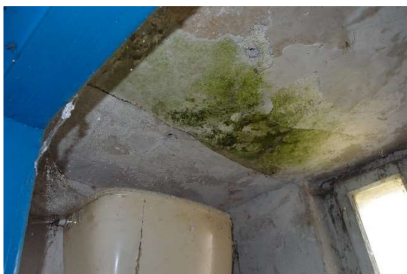
Obr. 47 – Plíseň na podhledu nad místností 1.12
