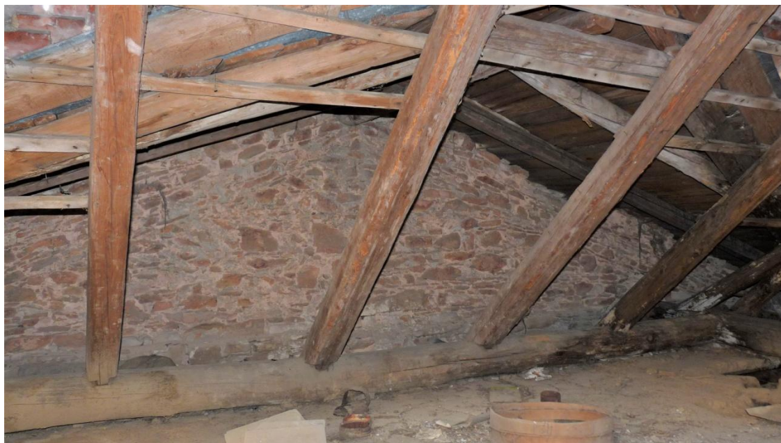
Obrázek 43 – Uzpůsobení krovu v oblasti sev. rizalitu vč. viditelného napadení houbou, 2018
