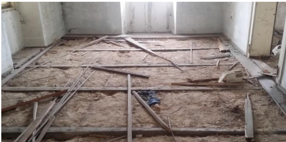
Obrázek 37 – Pozůstatky po odcizení pochozích vrstev podlahy ve 2.NP vých. křídla, 2018
