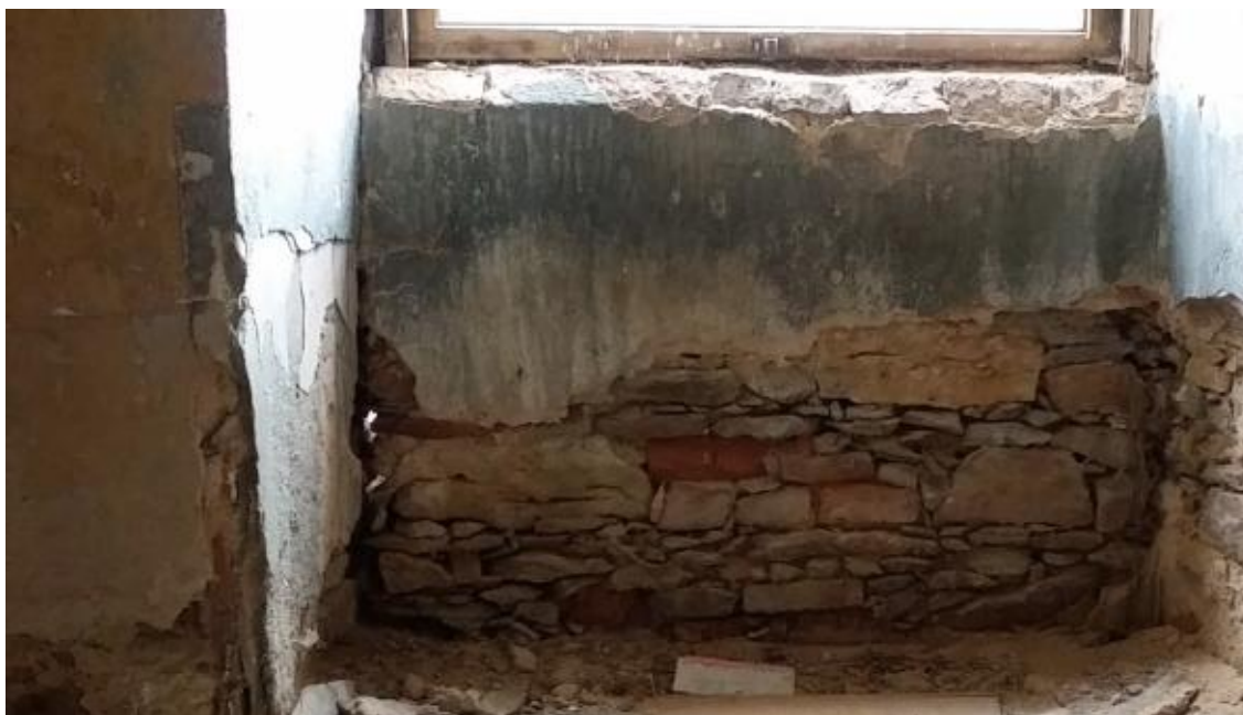
Obrázek 24 – Trhlina v obvodovém zdivu jihovýchodního rohu z interiéru, 2018
