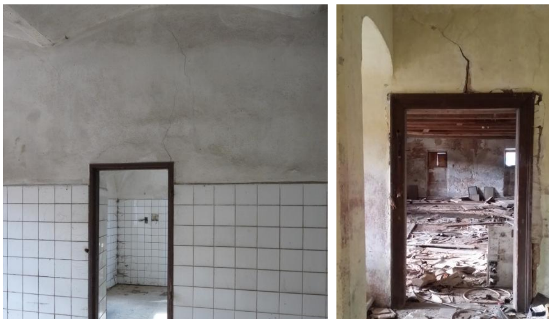
Obrázek 27,28 - Projevy oboustranných trhlin po výšce nosných konstrukcí v objektu, 2018
