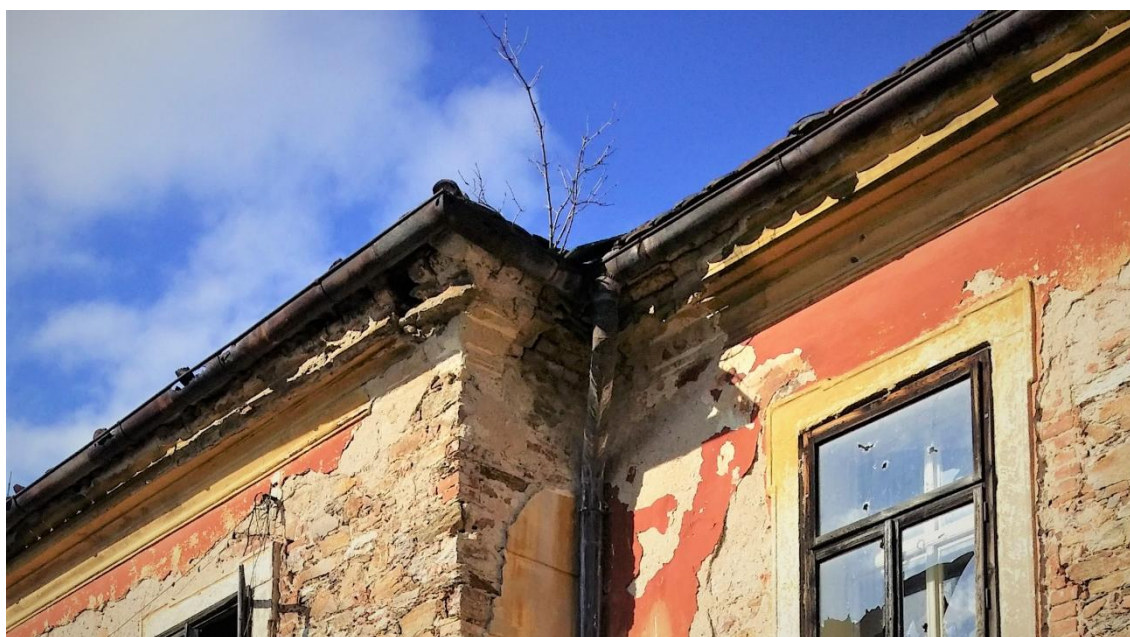
Obrázek 46 – Poslední ucelené pozůstatky po okapních žlabech a svodném potrubí, 2018
