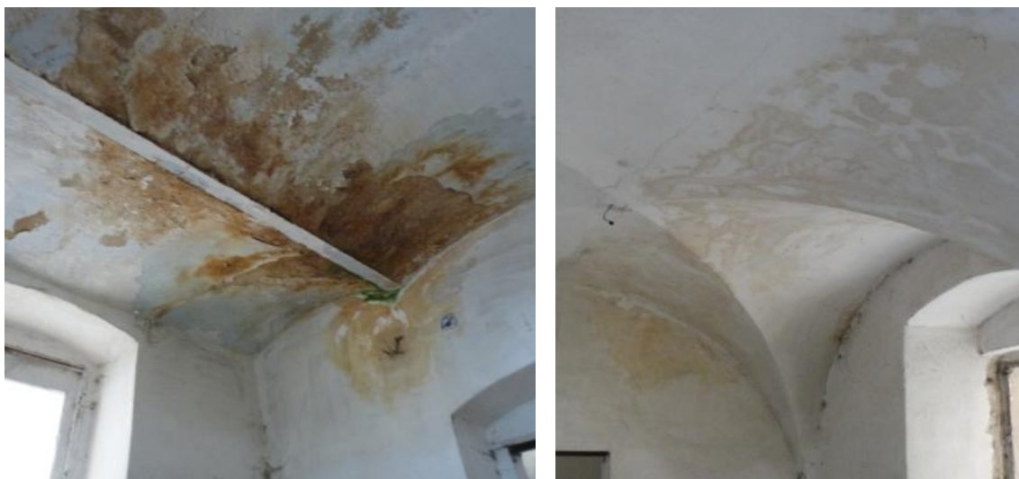
Obrázek 32,33 – Stav některých kleneb v 1.NP západního křídla, 2018
