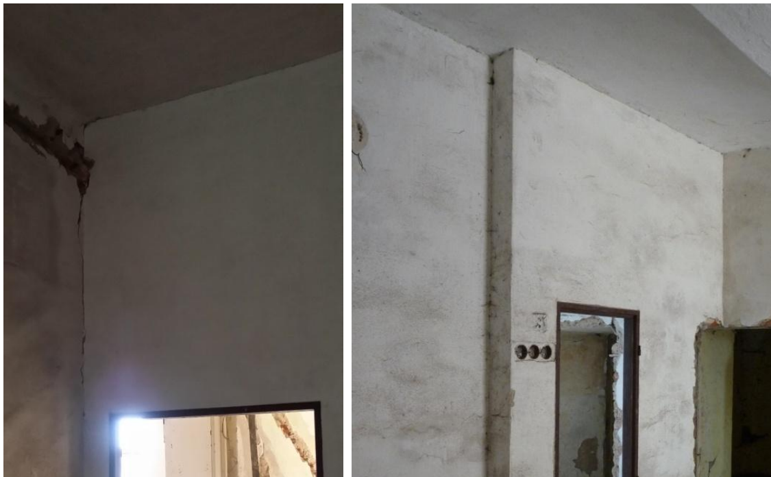
Obrázek 30,31 – Vznik trhlin příček u napojení na nosné konstrukce, 2018
