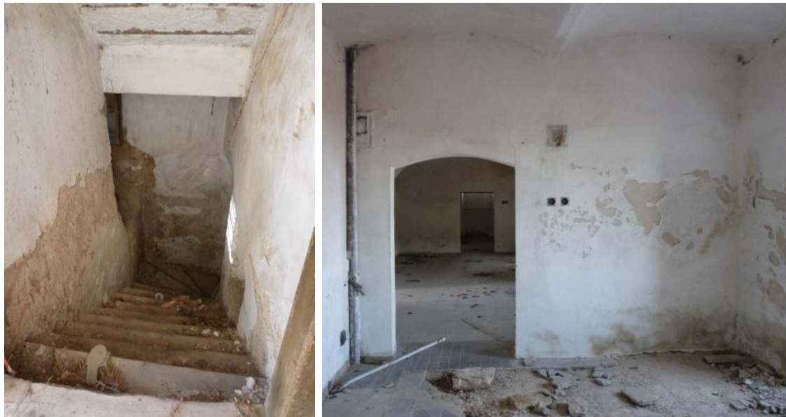
Obrázek 25,26 – Vizuálně potvrzené působení vlhkosti na omítky u jižního a severního rizalitu, 2018
