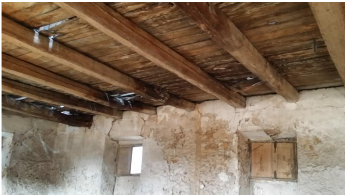
Obrázek 35 – Poškození stropu nad 2.NP v západním křídle, 2018
