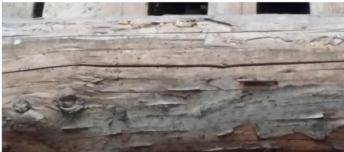
Obrázek 44 – Výletové otvory nejspíše červotoče nacházející se v celé konstrukci krovu, 2018
