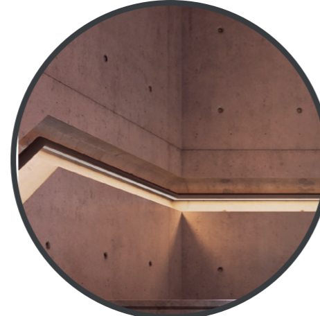
ZÁBRADLÍ SCHODIŠTĚ VE VSTUPNÍ HALE BUDE VYTVAROVANÉ V KONSTRUKCI A PODSVÍCENÉ LED PÁSKOU
