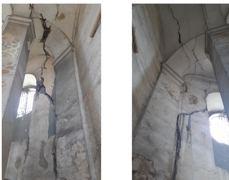
Obrázek 27: Praskliny v jihovýchodní zdi kostela
