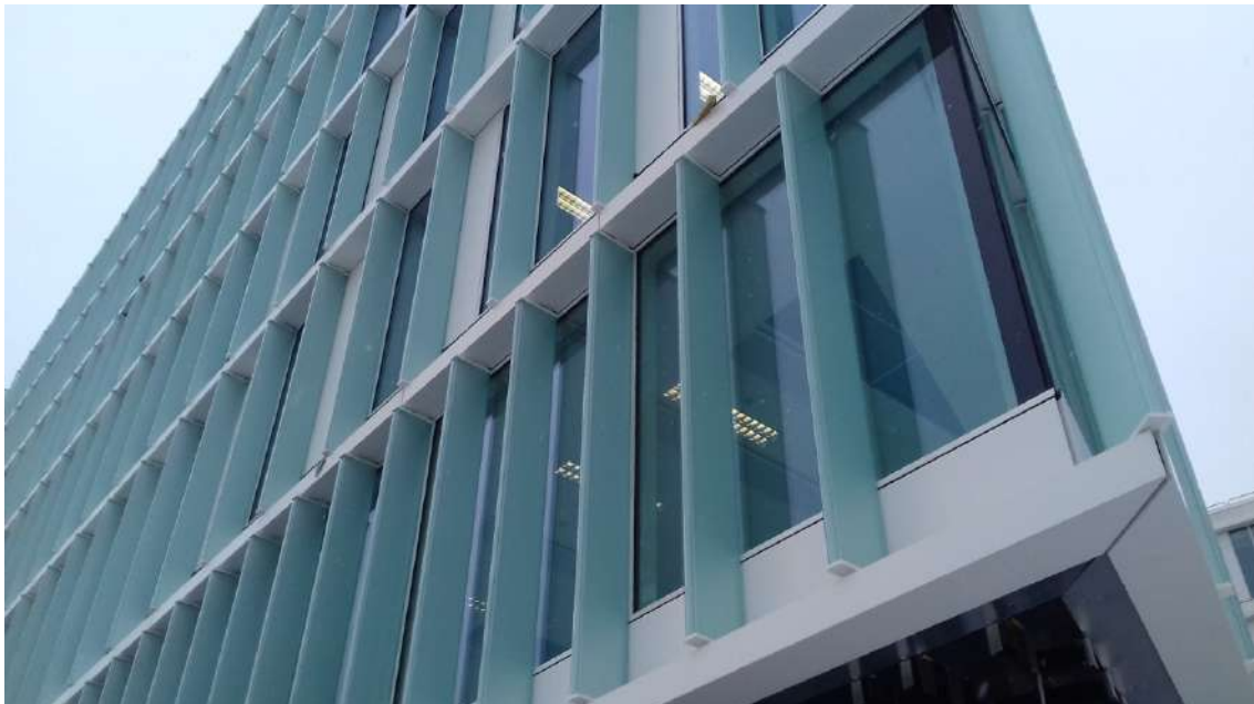
Obrázek 11: Stínění předsazenou vodorovnou římsou a svislými lamelami z profilovaného skla s pískováním (zdroj: vlastní fotodokumentace)
