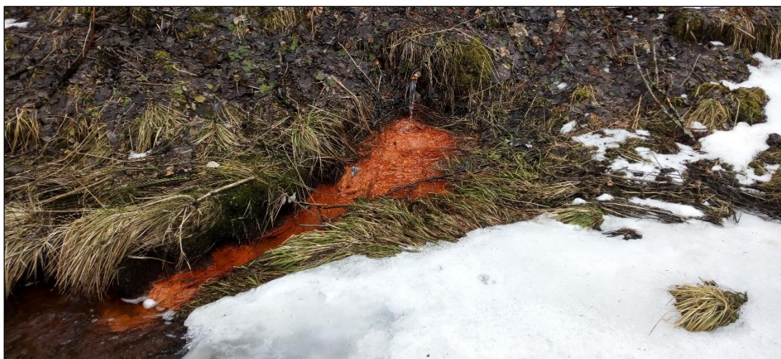
Obrázek 3.3 – Výron podzemní vody na vzdušném líci nevyužívané nádrže
