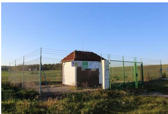
Foto č. 53 (Rozvodna plynu)
