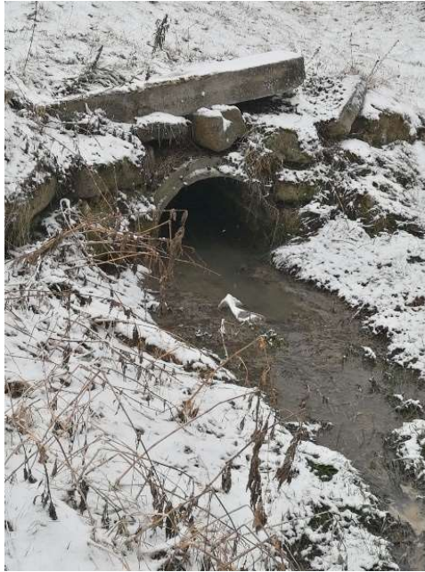
Obrázek 10 - Propustek DN 500 mm, v ř.km 6,790
