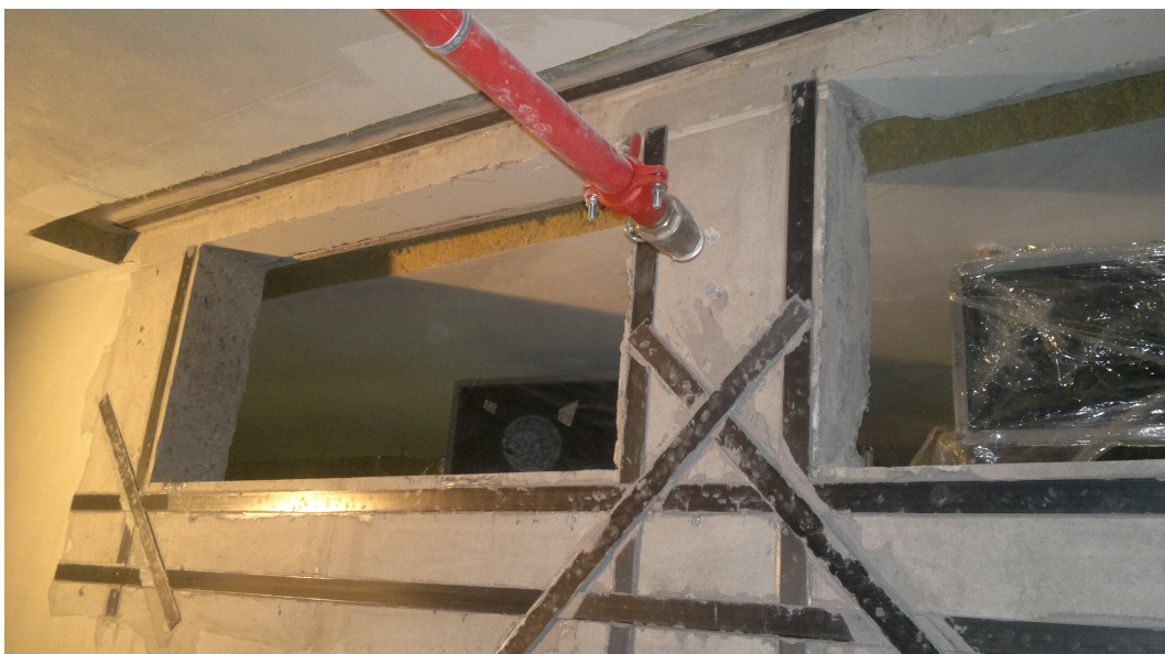
Obr. 28: Prostupy opatřené uhlíkovými lamelami (vlastní foto)
