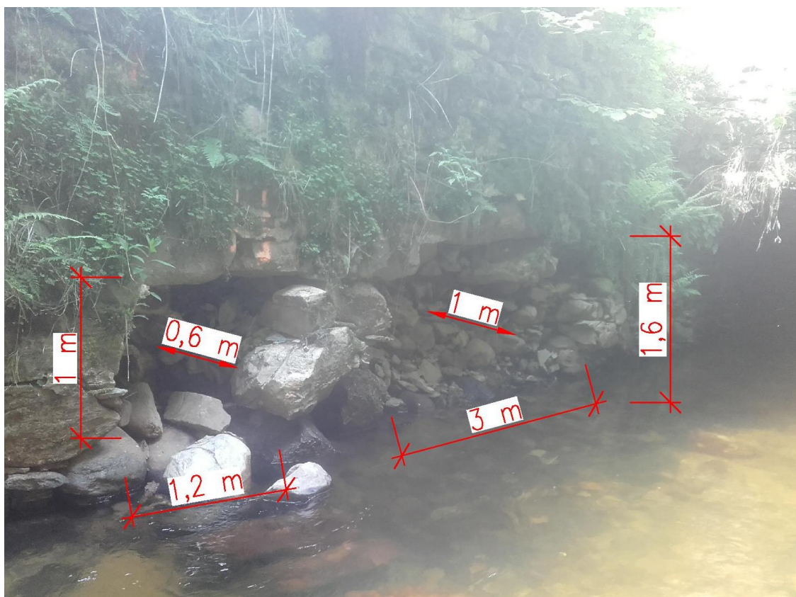
obr. 3.3 – Kaverny v pravé dělicí zdi, jaro 2018
