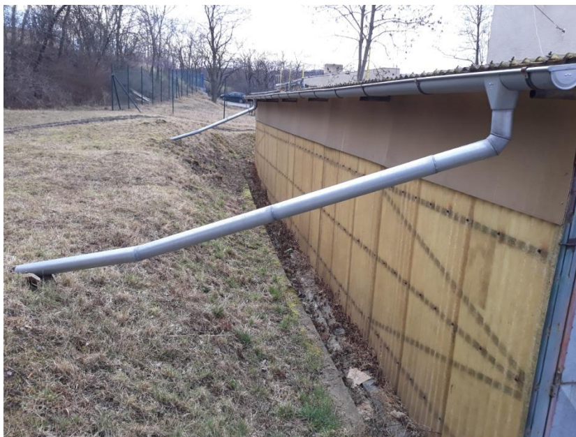
Obr.č. 33: Provizorně řešené dešťové svody z haly. Netradiční řešení v kontextu se zaneseným odvodňovacím rigolem u stěny haly.
