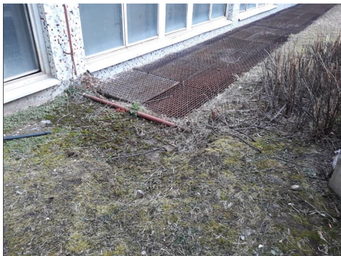
Obr.č. 26: Závada parapet nízko nad úrovní okolního terénu. Stav kabelového kanálu i kabelů uvnitř nebyl zřejmě předmětem dostatečné kontroly; rovněž úprava okolního terénu nebudí dojem plánované koordinované údržby.
