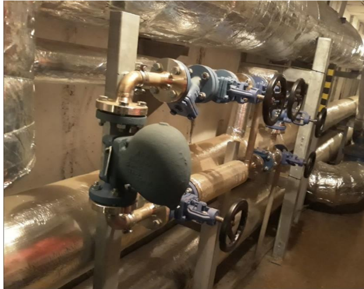
Obr.č. 18: Ukázka soustavy šoupat na horkovodním potrubí, které je uložené v kolektoru Zdroj: vlastní zpracování
