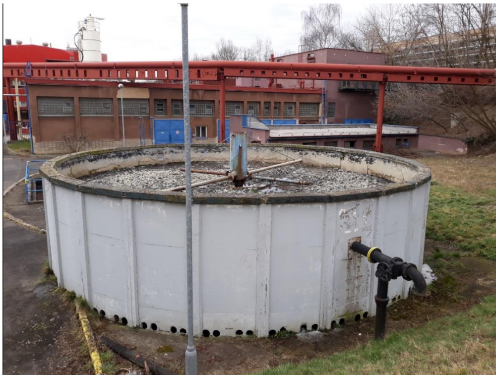
Obr.č. 21: Fotografie biologického filtru, ve kterém probíhá biologické čištění odpadních vod Zdroj: vlastní zpracování
