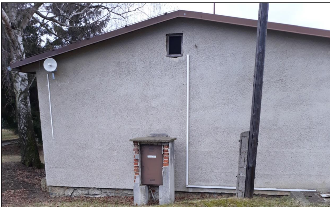
Obr.č. 27: Obrázek ukazující častý výskyt improvizace v případě dílčích rozvaděčů elektrické energie. Dále je na obrázku vidět neidentifikované kabely instalované po fasádě objektu a „zapomenutý“ stožár venkovního vedení.
