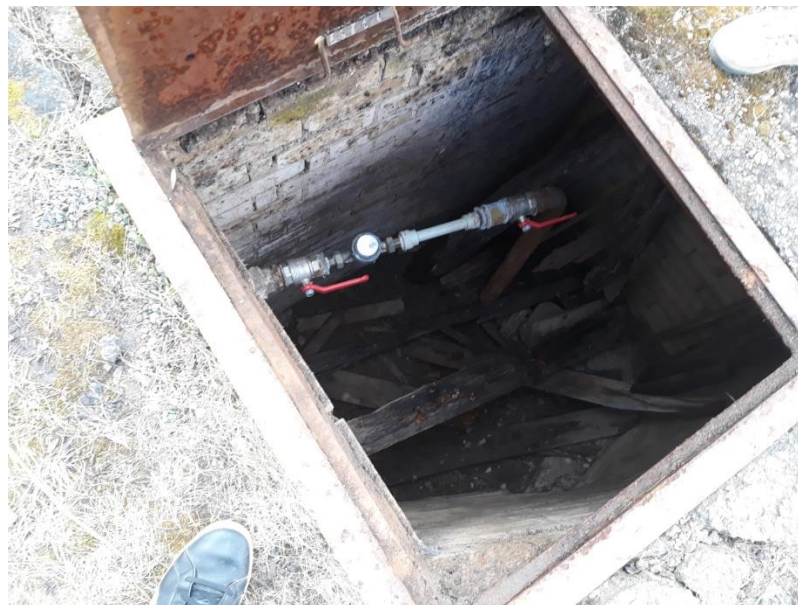
Obr. č. 29: Neudržovaná vodoměrná šachta, která je volně přístupná a občas slouží jako „skladiště dřevěného odpadu“ i jiného odpadu
