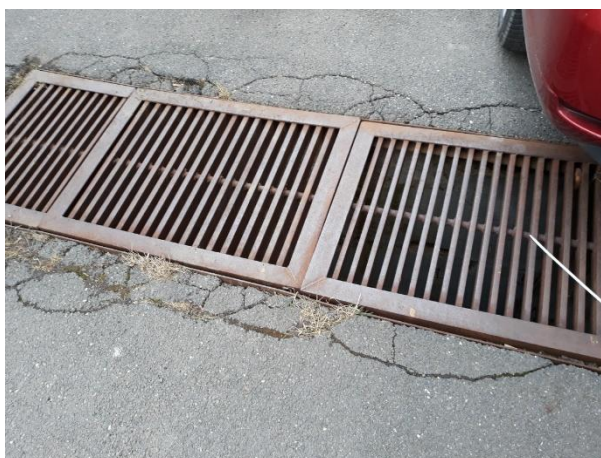
Obr.č. 34: Ventilační poklopy kolektoru, které nejsou v nejlepší kondici. Tento stav nebude důvěru adekvátního řešení dnešním požadavkům
