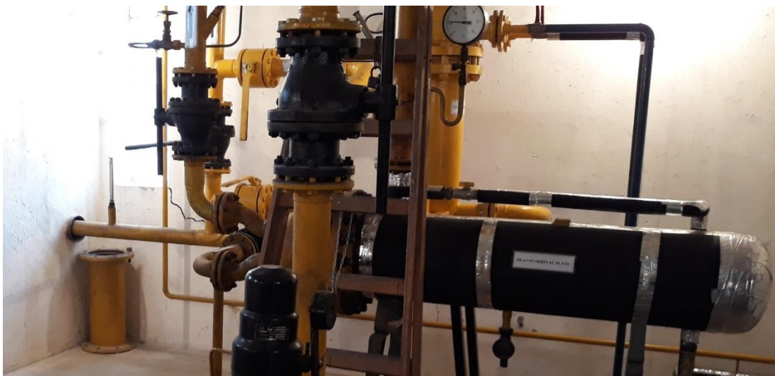
Obr.č. 14: Fotografie regulační linie PRS VTL/STL, NTL – pohled na hlavní ohřivač zemního plynu
