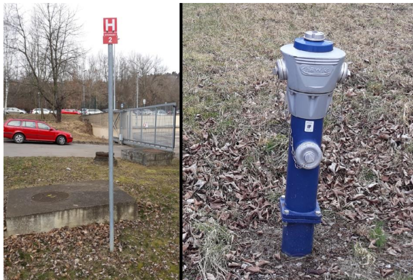
Obr.č. 23: Fotografie hydrantů, které se vyskytují v areálu FNM.
