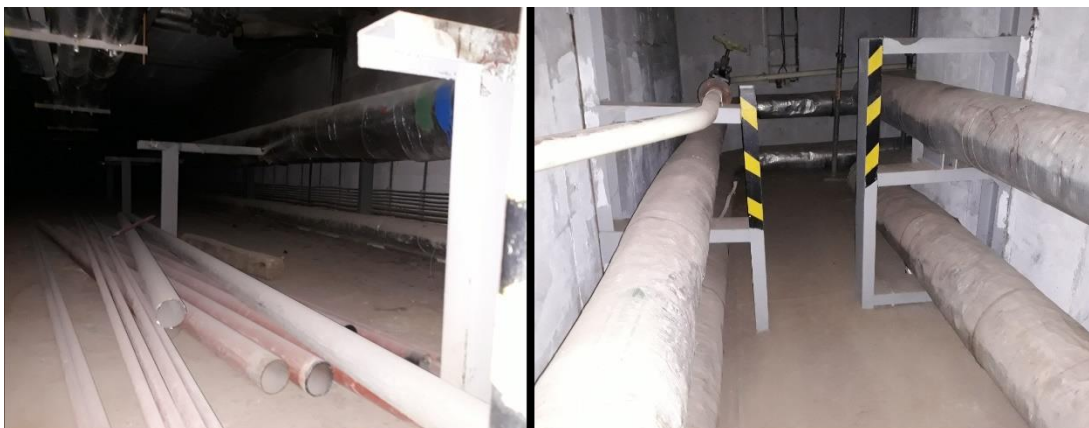
Obr.č. 35: Na obrázcích je vidět rozdílná provozní údržba technických chodeb. Na obrázku vlevo je provozní údržba technické chodby zanedbaná. V technické chodbě zůstalo pohozené staré ocelové potrubí. V případě nutného vstupu a prozkoumání chodby, vytváří nepořádek možné riziko úrazu nebo znepřístupnění části technické chodby. Opačná situace je vidět na pravém obrázku, kde je provozní údržba dobrá a technická chodba je snadno přístupná a průchozí.
