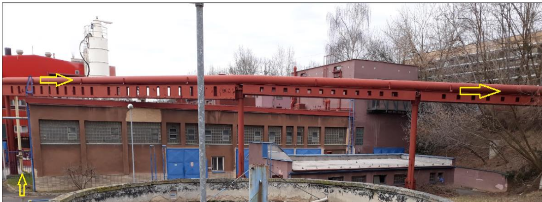
Obr.č. 11: Fotografie NTL potrubí jdoucí od ČOV dále k objektu prádelny na společné konstrukci s potrubní poštou. Plynovodní potrubí NTL je uloženo za potrubím potrubní pošty.
