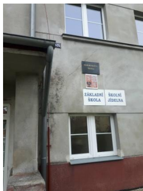
(obr.4 Poničení čelní části)
