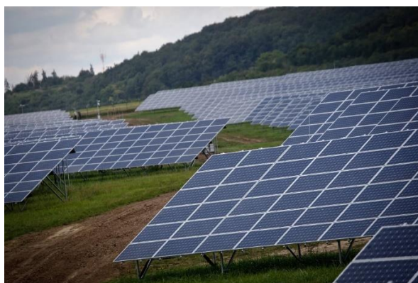
Obrázek 3 Fotovoltaická elektrárna Vepřek
