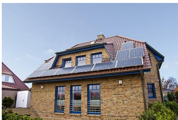
Obrázek 4 Fotovoltaický systém na rodinném domě
