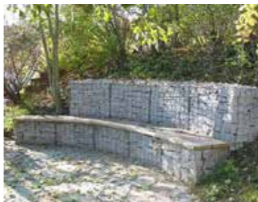
Lavice gabionová Betafence s opěradlem, sloužící zároveň jako opěrná zeď svahu Výška: 45 cm Sedátko: tepelně upravená borovice Zhotovené na míru, l=2-3 m
