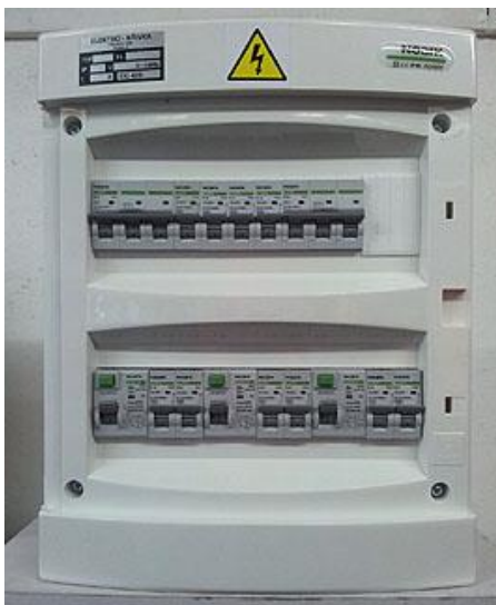
Obrázek 6. Domovní rozvaděč (Elektro-Křivka)
