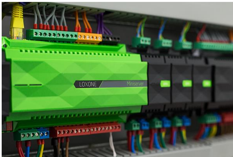
Obr. 2 - Instalace Miniserveru a rozšiřujících modulů Extensions [2]
