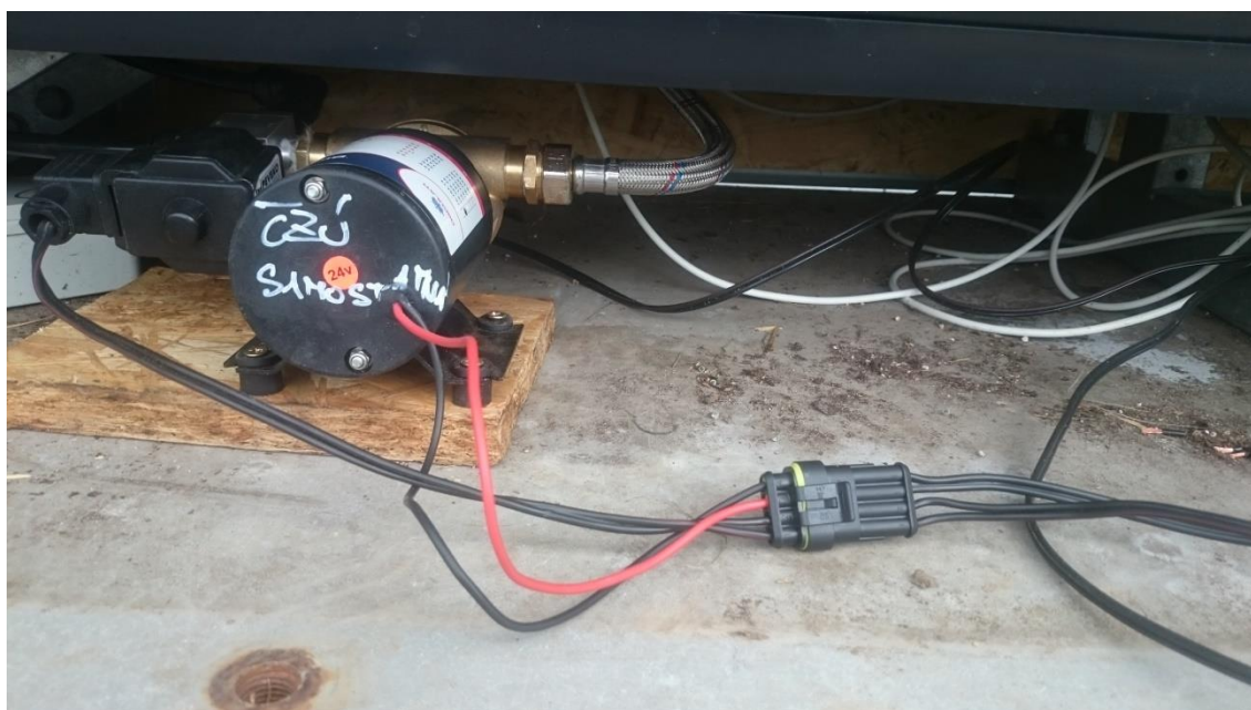
Obrázek 3.5 Čerpadlo a třicestný ventil s konektorem superseal, instalované v lavičce ČZU
