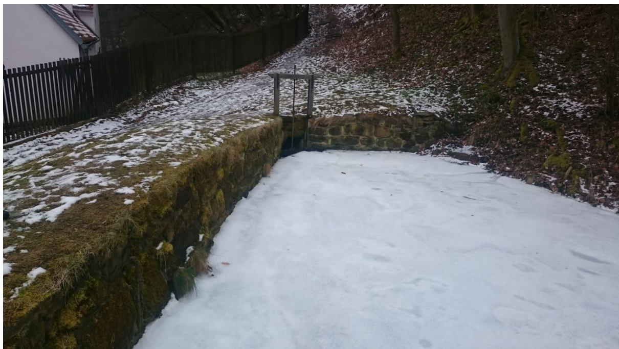
Obr. 15. Stavidlo nádrže mlýnského náhonu (autor BP)
