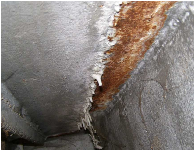
Obrázek 34. Výluhy způsobené zatékáním vody do konstrukce, jednoznačný důsledek nesprávného odvedení vody (deska mostovky na Žďákovském mostě)
