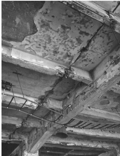
Obrázek29. Poškození z důsledku požáru [14]
