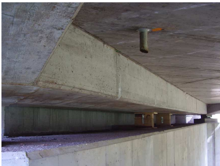
Obrázek 35. Konstrukce narušená ohybovými trhlinami a následnými výluhy pojiva. Konstrukce byla dočasně podepřena. (Most v Očihově, nedostatečně vyztužený příčník)
