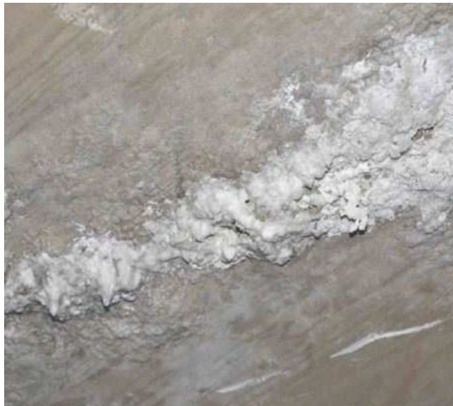
Obrázek 27. Výkvěty na betonu - krusta uhličitán vápenatý [1]
