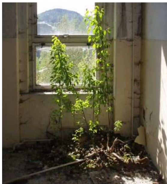
Obrázek 30. Koroze betonu vlivem průniku kořenů [1]
