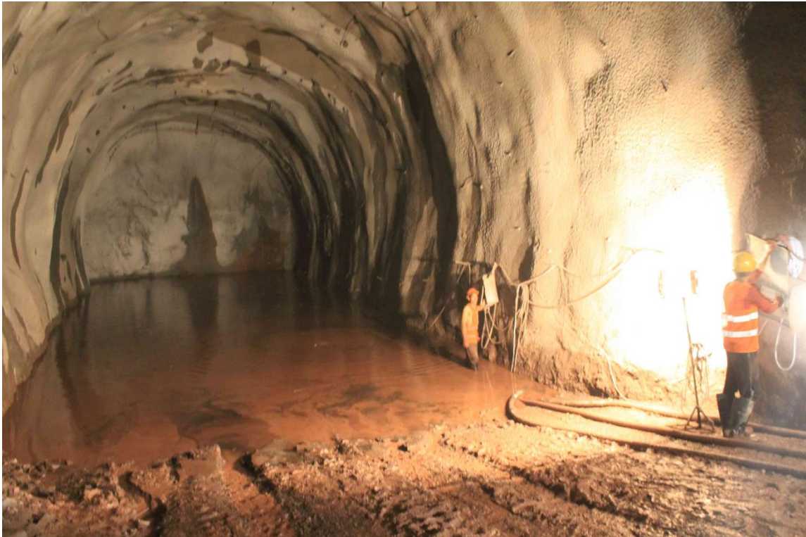
Obr. 4.2 Postupné zatopení úpadní ražby tunelu v délce dosahující 100 m. Důvodem byl přítok podzemní vody přes špatně utěsněný 12 m dlouhý předvrt, který byl realizovaný ve spodní části čelby, úpadní ražba a nedostatečné odčerpávání. Ražba byla přerušena na dobu dvou týdnů – dlouhodobý prostoje.
