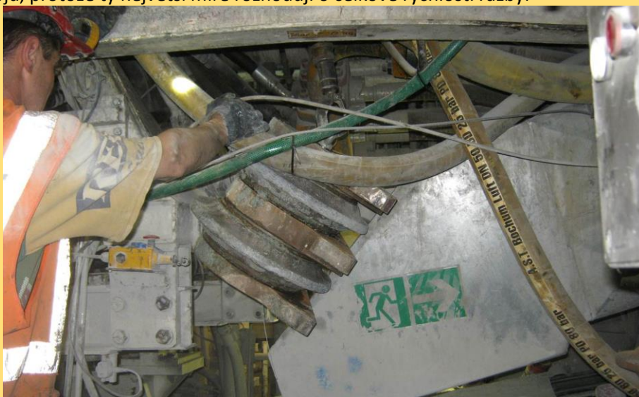
Obr. 7.46 Náročná výměna poškozeného centrálního dvojitého disku, v tomto případě 1 hod, projekt Ejpvovice.
