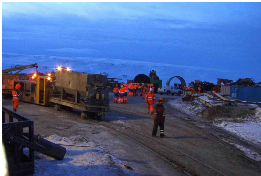
Obr. 7.24 Vykolejení lokomotivy s mixem před portálem přerušilo dodávku betonu na čelbu. Z toho důvodu musel tunelovací stroj přerušit ražbu.
