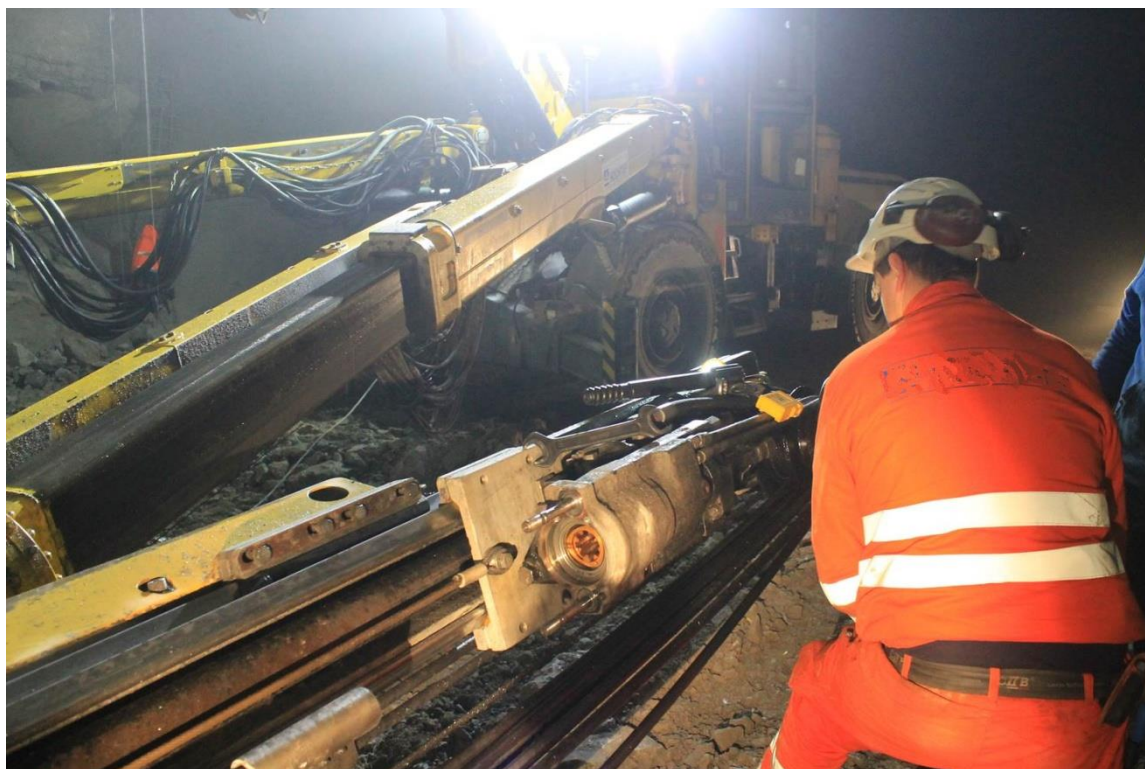
Obr. 4.1 Výměna zlomeného adaptéru na lafetě vrtné soupravy, na kritické cestě. Vrtání čelby a veškeré činnosti na čelbě přerušeny po dobu dvou hodin – střednědobý prostoje.
