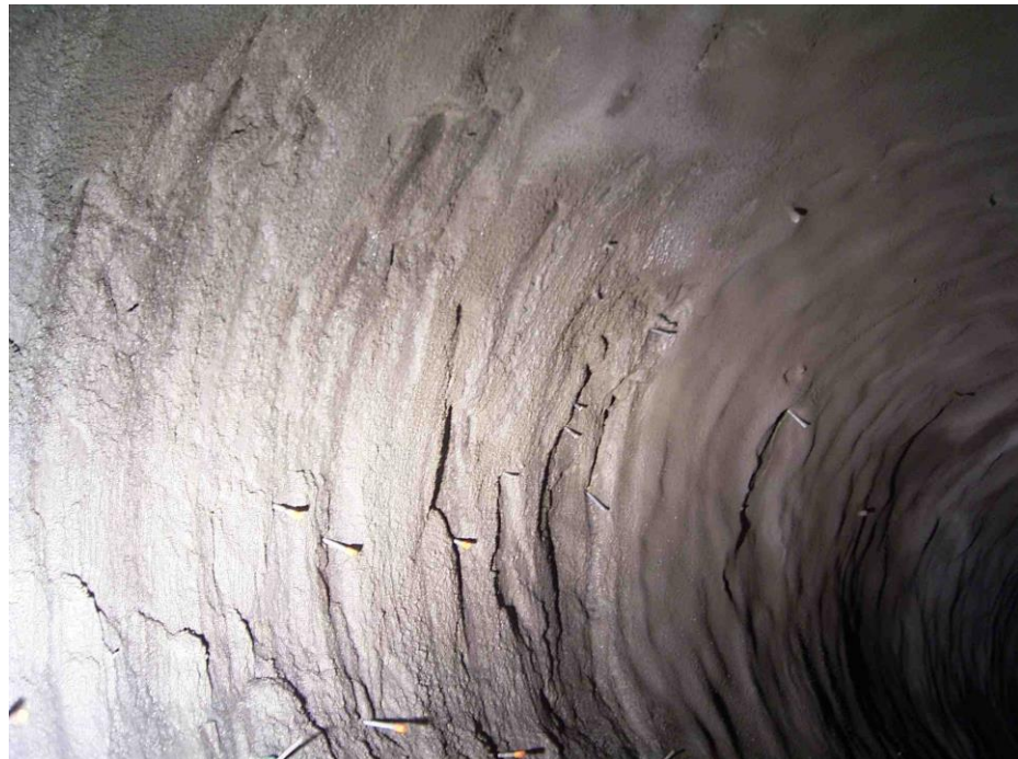
Obr. 7.21 Na stěně jsou patrné žlaby a relativně velké plochy po vyplaveném nastříkaném betonu a drenážní trubky v tunelu o průměru
