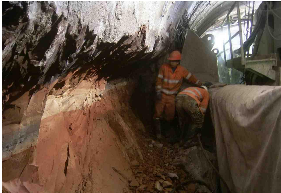
Obr. 7.22 Výrazné a časté nadvýlomy při ražbě pomocí TBM na pozicích 8 a 4 hodin, způsobené méně pevnější 2 m mocnou vrstvou sedimentů, subhorizontálně upadající ve směru ražby. Problém zesílil při kontaktech s rozpěrnými deskami tunelovacího stroje.
