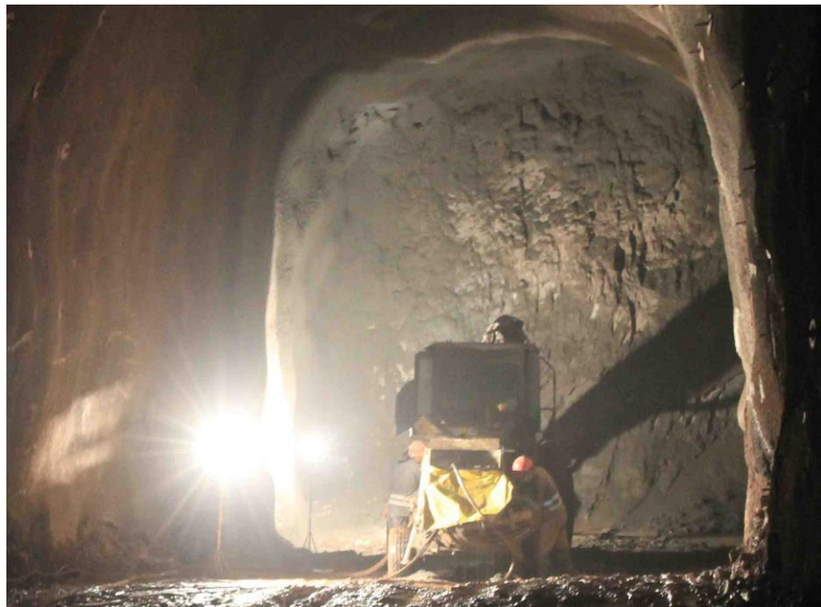
Obr. 7.26 Čištění stříkací soupravy ihned po aplikaci nástřiku, avšak na čelbě, tudíž na kritické cestě.
