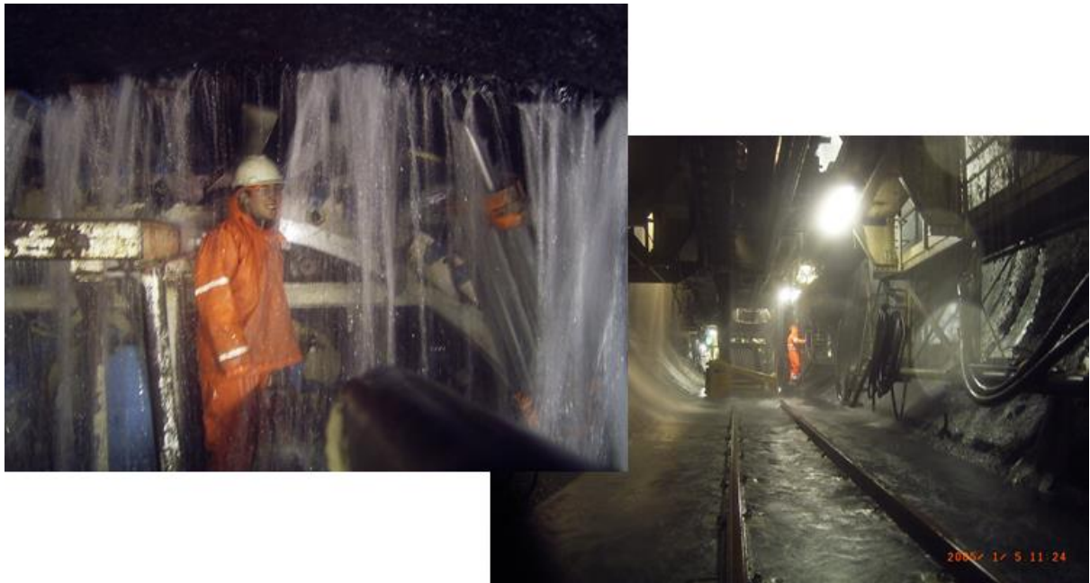
Obr. 4.17 Přítoky podzemní vody do výrubu při ražbě TBM otevřeného typu a často zatopená počva, projekt Kárahnjúkar, Příloha 1.
