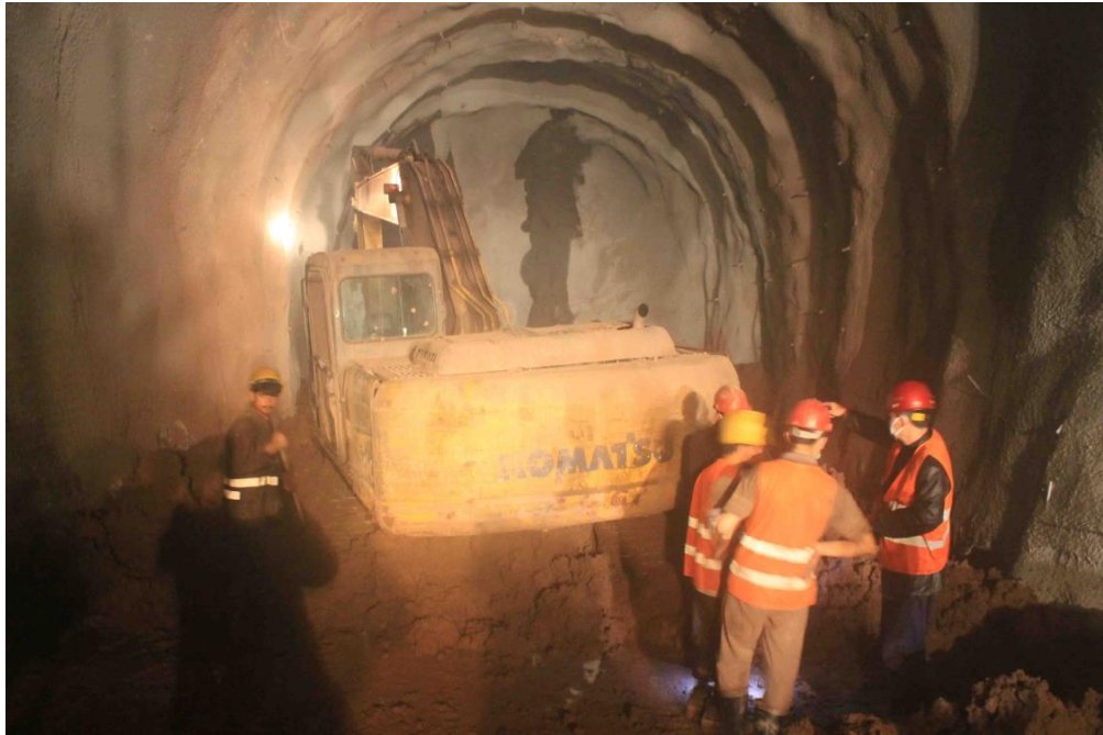
Obr. 7.11 Uvíznutí tunelbagru na čelbě v lepivé rubanině.
