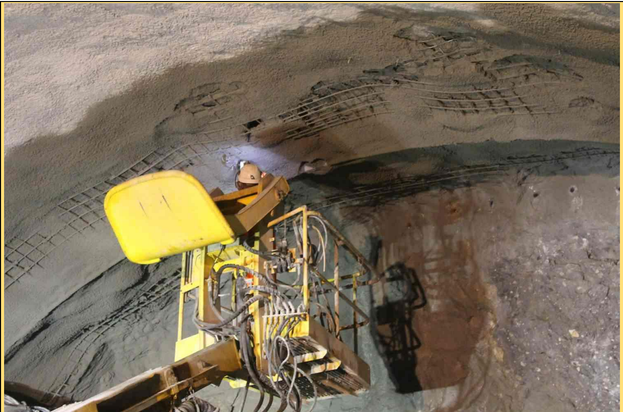
Obr. 7.30 Nekvalitní betonová směs s nízkou přilnavostí, která krátce po nástřiku opadávala z klenby. Na obrázku nahoře jsou patrné vyboulené části ocelové sítě, které byly zatíženy a prohnuty odpadlým betonem, a to i v případech nástřiku 2. vrstvy s/b.
