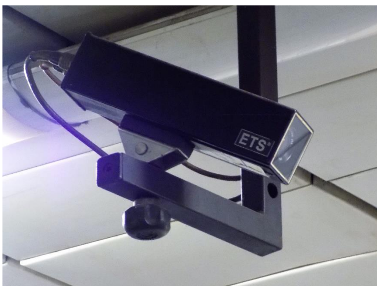
Obr. 17 – Kamera ve stanici Hlavní nádraží – zdroj autor
