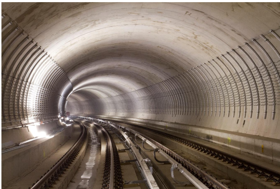
Obrázek 8 Dvoukolejný tunel metra, uprostřed je vidět přívodní kolejnice Foto: DPP
