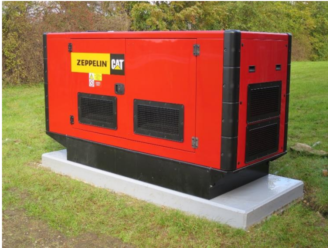
Obrázek 4 Elektrocentrála na Požární stanici Hostivař Foto: Ing Michal Brunner
