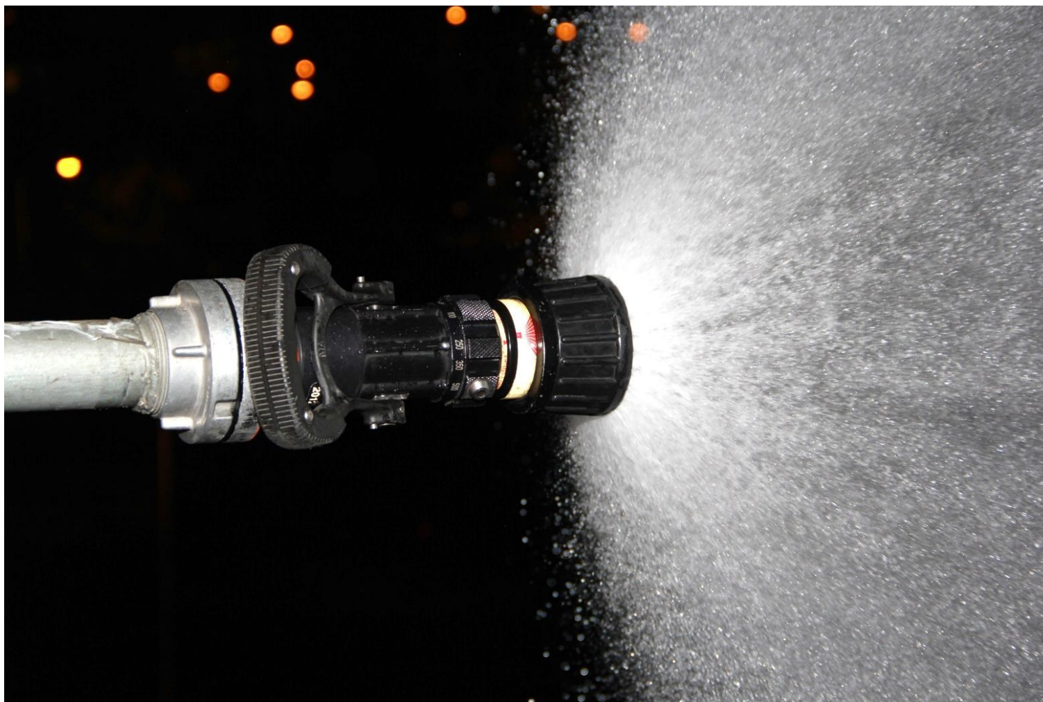
Obr. 33 – Detail na nastavení proudnice při měření s výškovým převýšením v hotelu Opatov v šestém nadzemním podlaží
