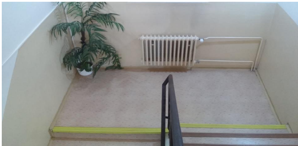
Obrázek 7: Nedostatečná šířka schodišťového ramene v budově č. 9 [vlastní]
