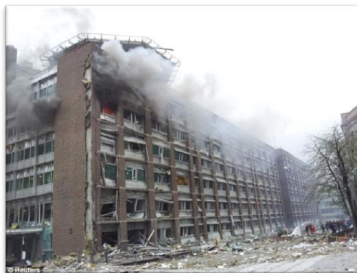
Obrázek 3 Poškození budovy následkem exploze výbušnin v zaparkované dodávce. [51]
