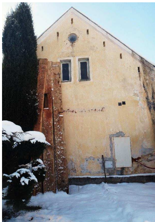
Obrázek 27 – Zatékání dešťové vody vlivem klempířských konstrukcí. (Zdroj: převzato z [5]).
