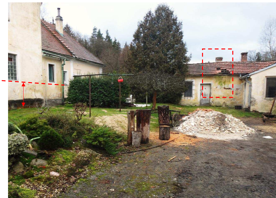
Obrázek 26 – Pohled na vlhké „mapy“ na severní fasádě a chybějící střešní tašky (Zdroj: převzato z [5]).
