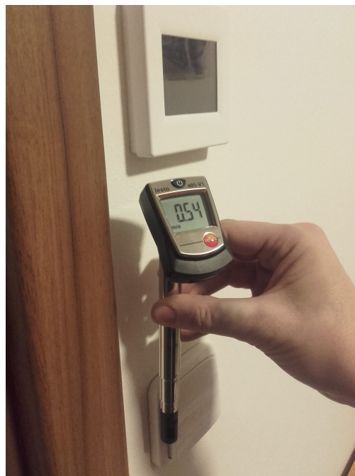
Ilustrace 11: Detekce netěsnosti - vypínač
