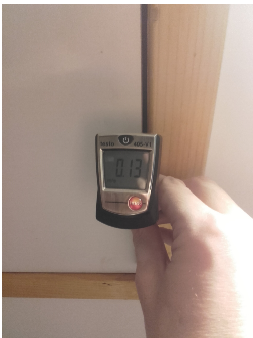
Ilustrace 12: Detekce netěsnosti - stahovací půdní schodiště
