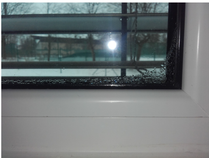
Ilustrace 27: Kondenzát na skle okna [4]
