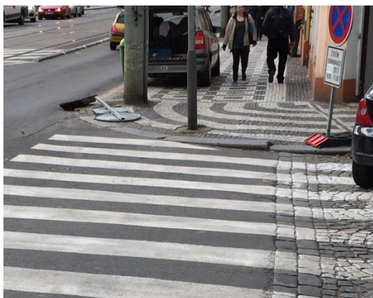
Obr. D36 – Přejchod pro chodce, severní rameno (SZ nároží); snížený obrubník není na celou šířku přechodu, hmatové úpravy nezřízeny
