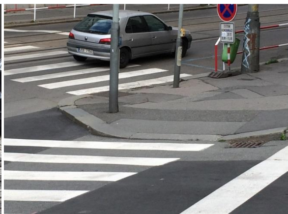
Obr. D37 – Přejchod pro chodce, jižní rameno (JV nároží); snížený obrubník není na celou šířku přechodu, hmatové úpravy nezřízeny
