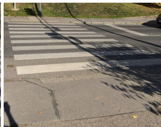
Obr. D96 – Přechod pro chodce, chybí vodící pás přechodu
