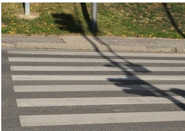
Obr. D95 – Čekací plocha východ; snížený obrubník není na celou šířku přechodu
