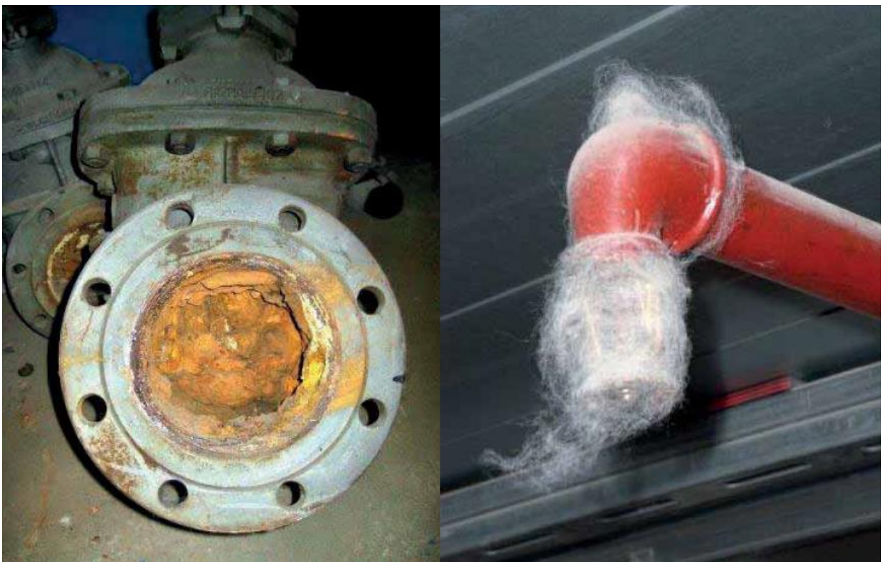
Obr. 1: Zanesené uzavírací šoupátko od rzi a sprinklerová hlavice zanesená vlákny (1)
