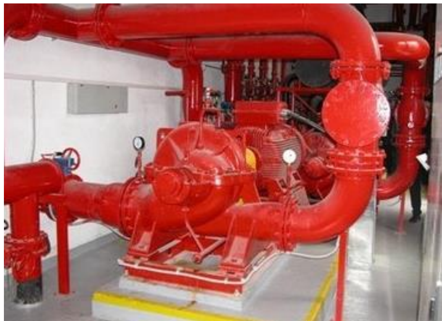
Obr. 8: Čerpací zařízení s pohonem elektromotorem
