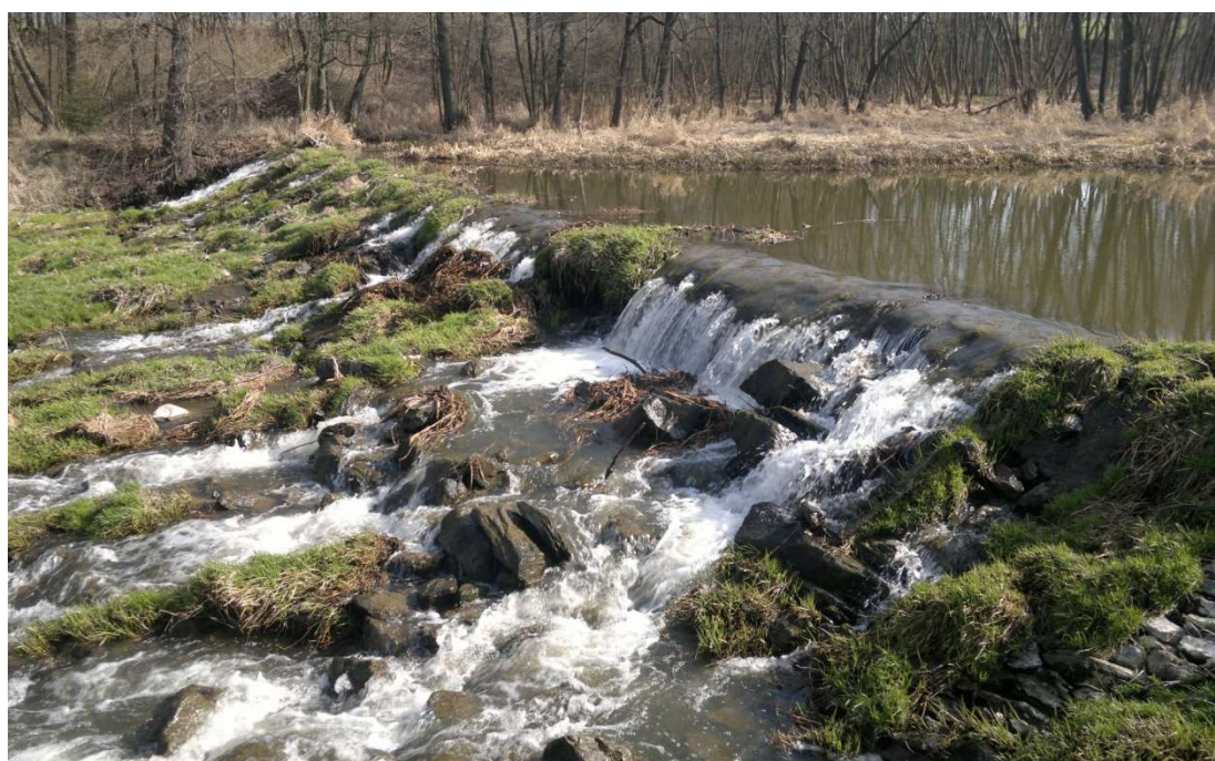
Obr. 5: Detail poškození jezu z levého břehu [6]
