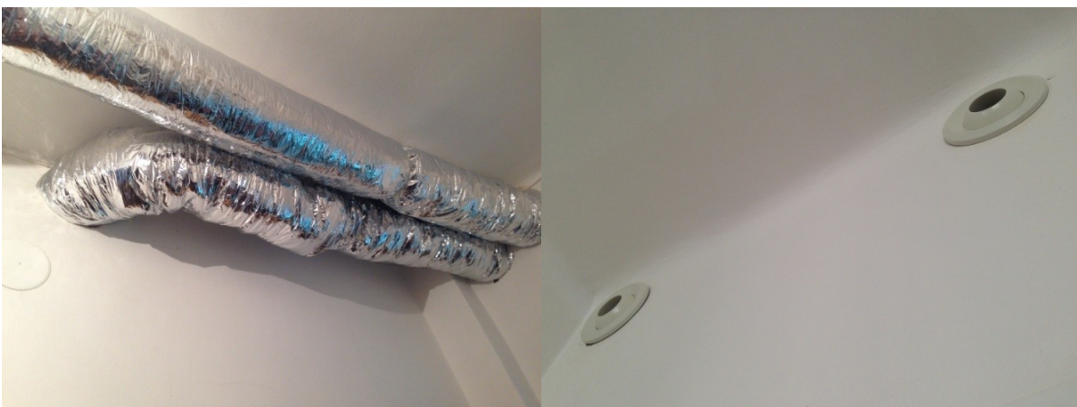
Obrázek č. 40 a č. 41: Potrubí vedené v chodbě bytu a distribuční elementy v pokoji (foto: autor)
