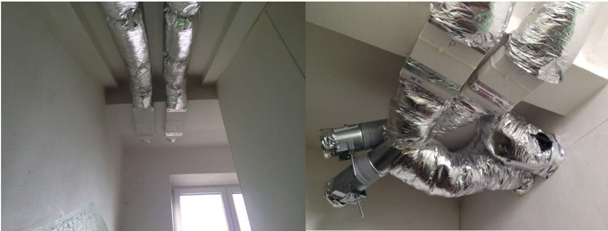
Obrázek č. 38 a č. 39: Vedení potrubí pod konstrukcí schodišťového ramena a prostup potrubí do bytu a příprava pro napojení dalších bytů (foto: autor)
