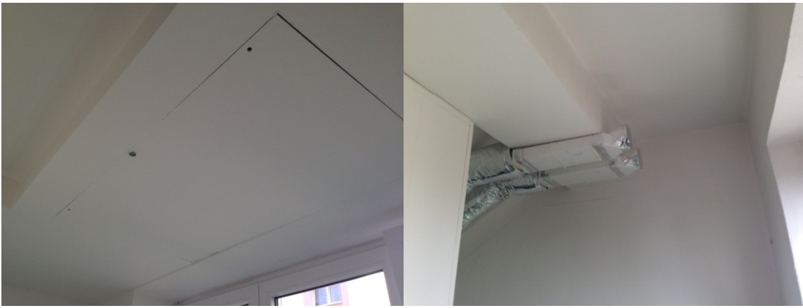
Obrázek č. 36 a č. 37: Revizní dvířka jednotky umístěná na stropě mezipodesty a příprava pro napojení jednotky na mezipodestě (foto: autor)
