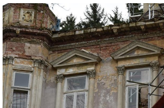
Odchlíplé omítkové vsrvy s viditelným okrovým nátěrem
