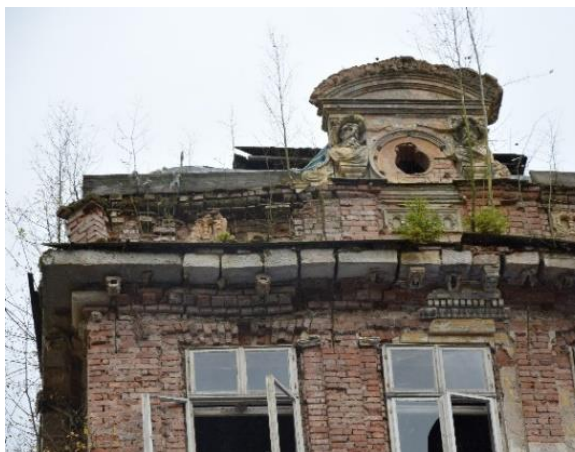
Poškozená římsa rizalitu a náletová zeleň
