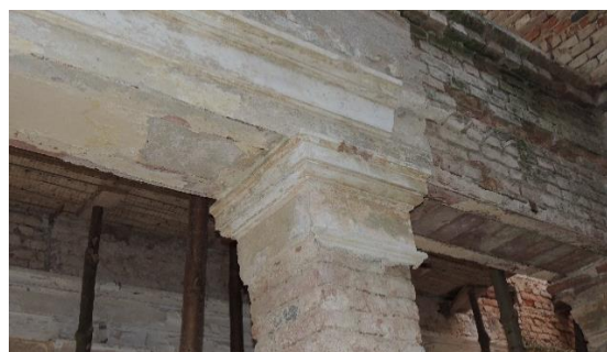
Překlad z ocelového profilu v místnosti 2.10
