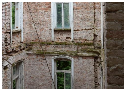
Kapsy po dřevěných trámových stropech 1.06
