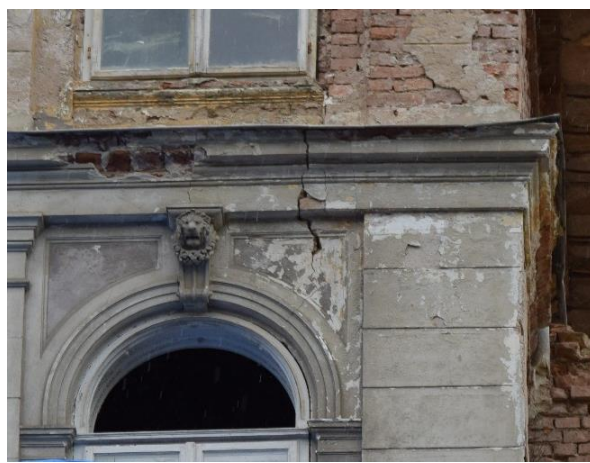
Trhlina rizalitu z exteriéru.
