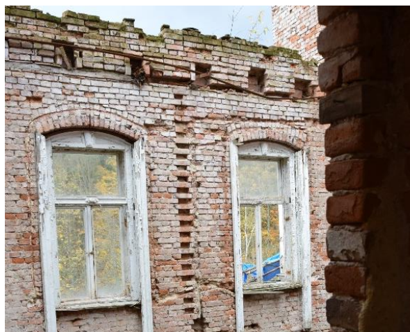
Poškozená římsa 2.NP z interiéru
