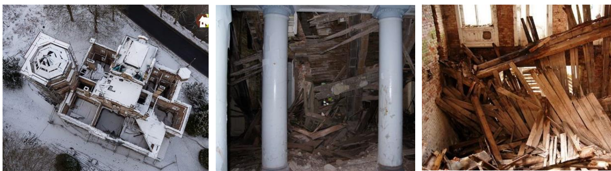
obrázek 6 Stav Mattoniho vily v roce 2013, zborcený krov a stropní konstrukce [01];[02]
