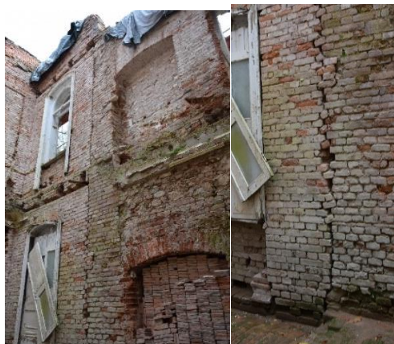
Trhlina objektu v místnostech 1.06; 2.08.
