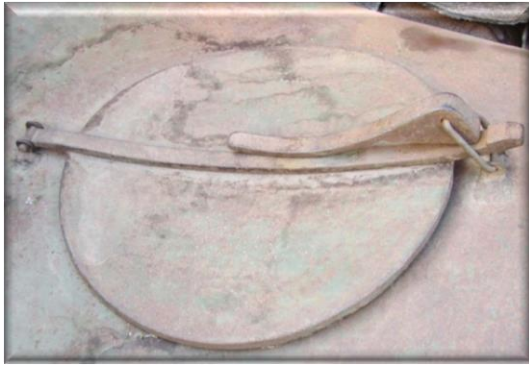
Obr. 65: Kontrolní otvor za podavačem prachu - zavřený
