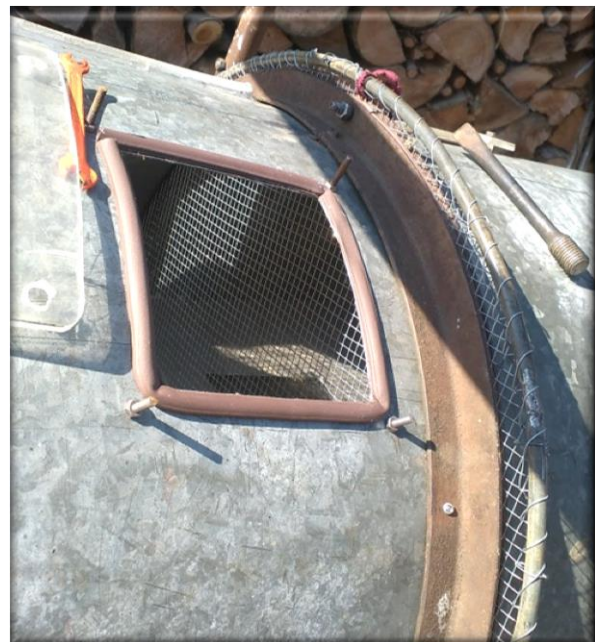
Obr. 82: Otevřené revizní okno
