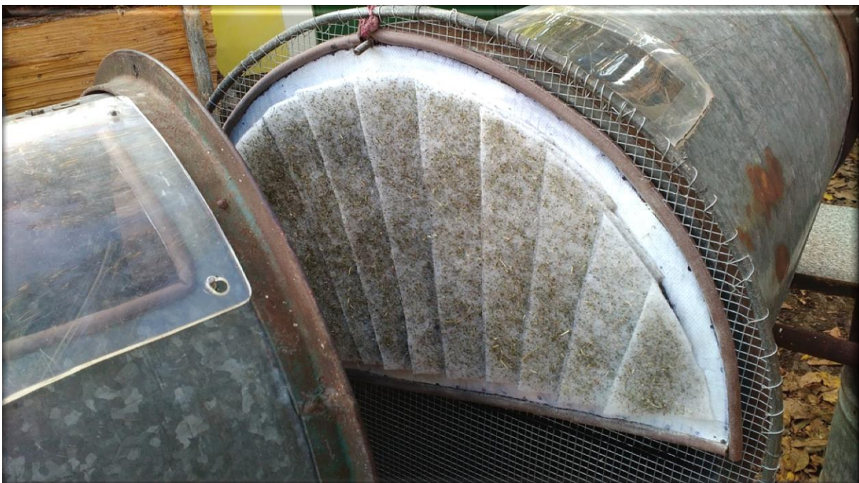
Obr. 123: Ukázka zanesení filtru po dokončení filtrační fáze
