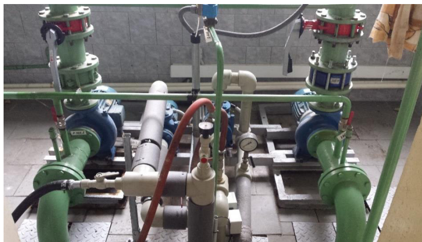
Obr. 27 Čerpadla – cirkulační jímka
