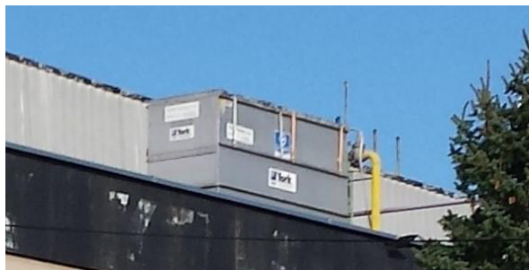
Obr. 18 Kondenzátor na střeše objektu
