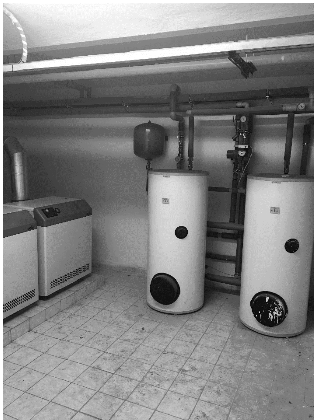
obr. 19 – Stacionární zásobníky TV a plynové kotle, 1.PP ZŠ Chlumín
