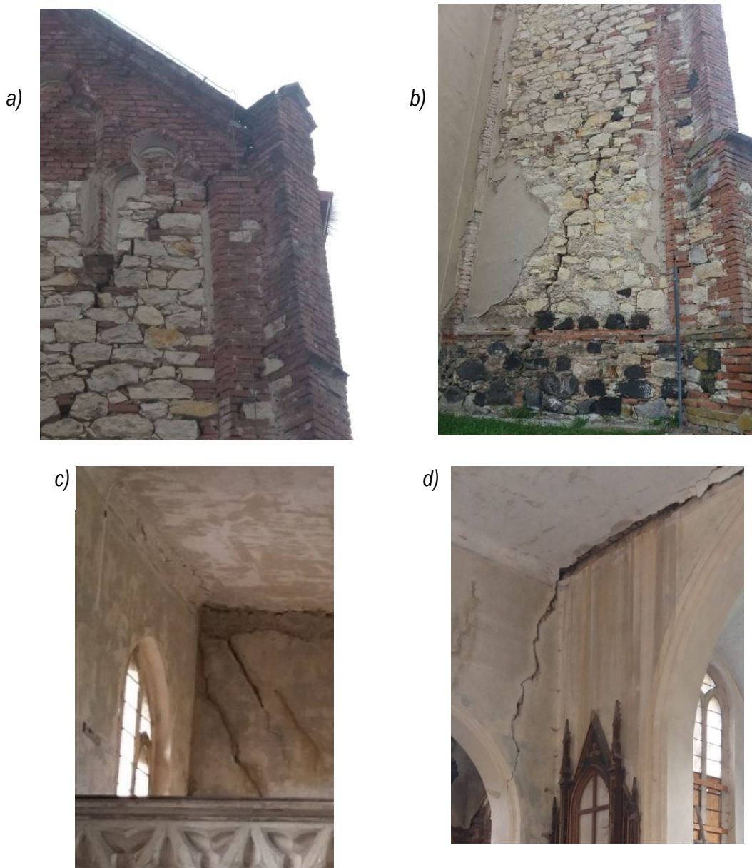
Obr. 56: Poruchy svislých nosných konstrukcí
