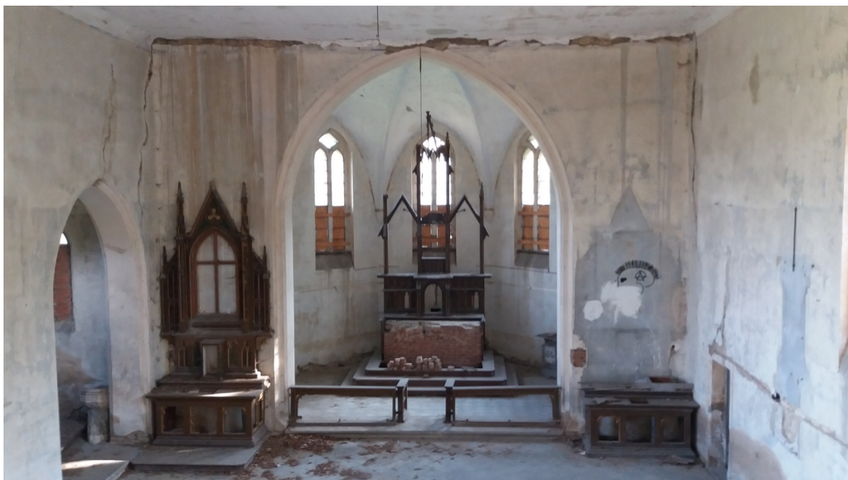
Obr. 57: Pohled na oltář (presbytář)- podélná prasklina podél střechy a praskliny v bočních stěnách
