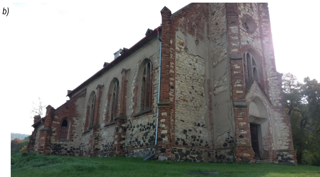
Obr. 54: Narušená fasáda dešťovou vodou hnanou větrem
