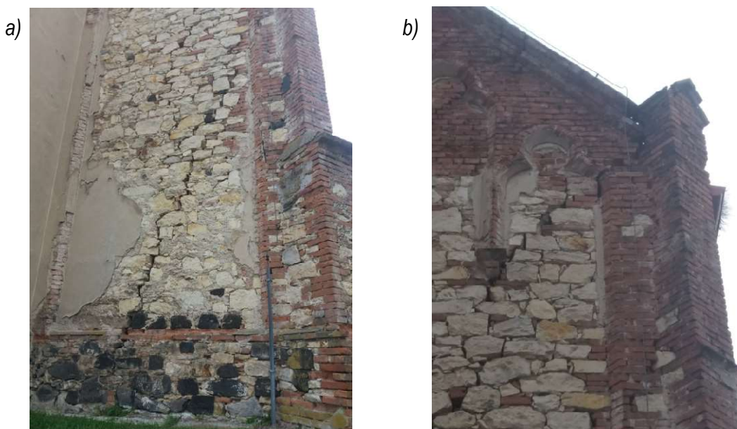
Obr. 9: a), b) Trhlina v průčelní stěně
