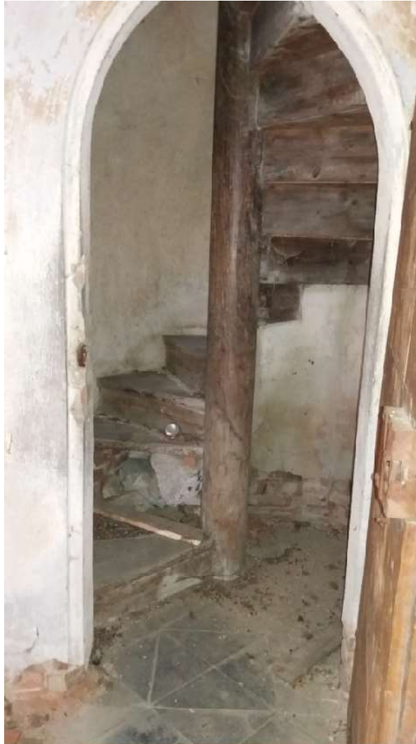
Obr. 60: Porucha schodiště- chybějící stupně
