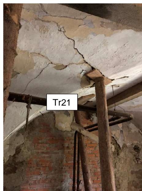
Obrázek 25 – značně trhlinami porušena křížová klenba v jihozápadní věži
