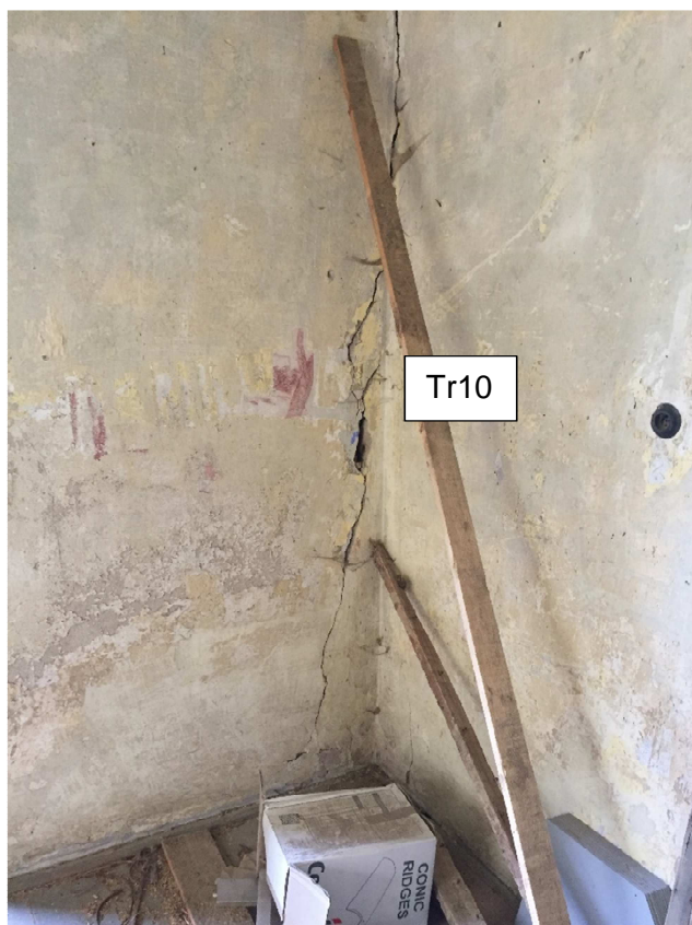
Obrázek 18 – Trhlina v severním rohu místnosti
