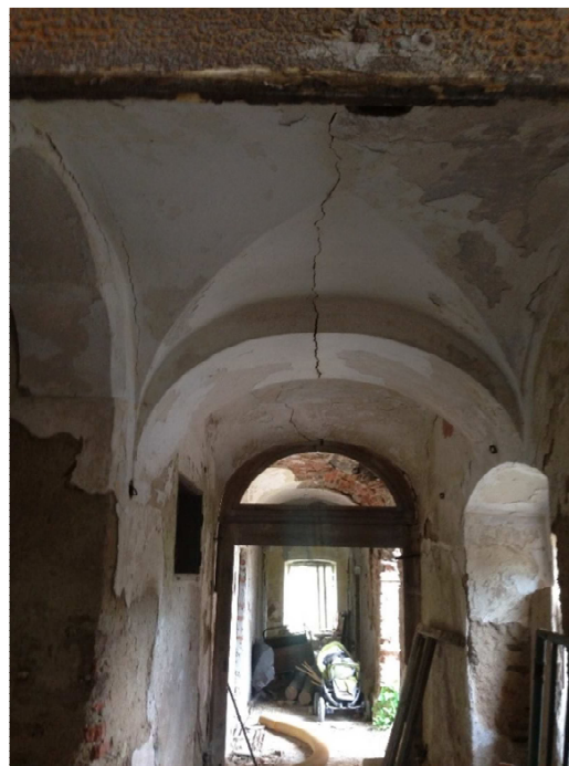
Obrázek 28 – pohled na trhlinu z jihozápadní strany chodby
