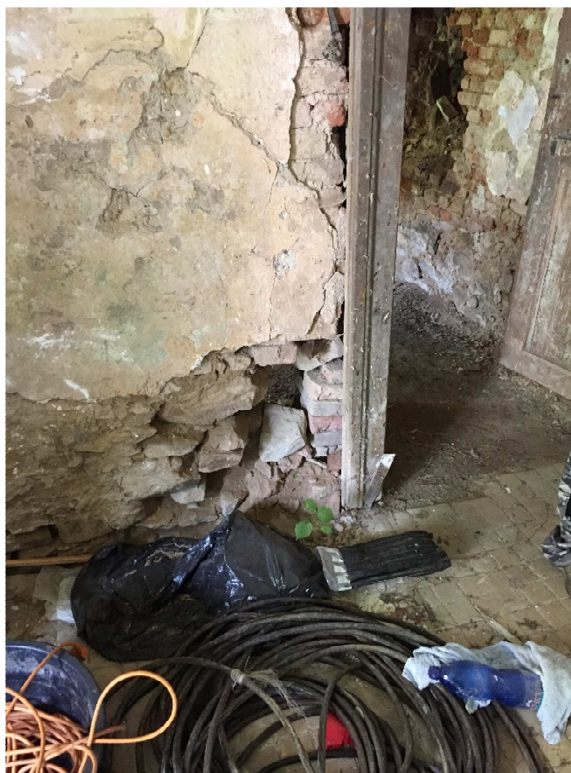
Obrázek 23- porušený sokl v místnosti 1.01
