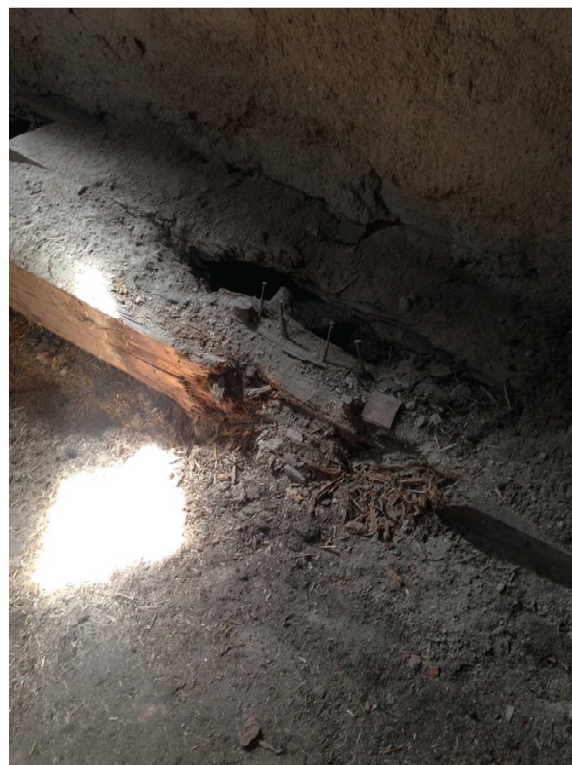
Obrázek 31 – degradovaný vazný trám ve střední v blízkosti komínového tělesa
