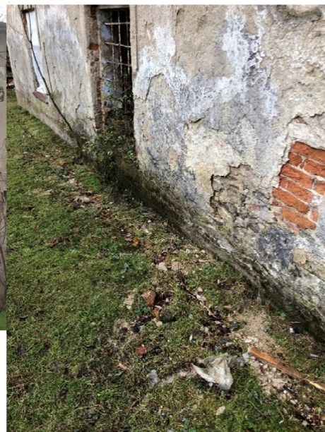
Obrázek 13 - detail zvýšené vlhkosti v obvodové stěně u soklové části
