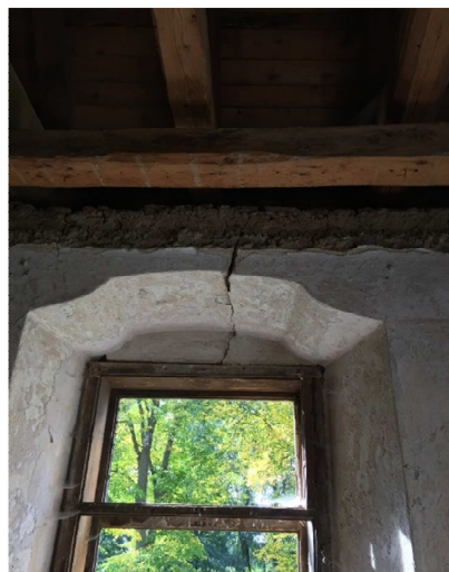
Obrázek 29 – trhlina v nadpraží okna jižního křídla
