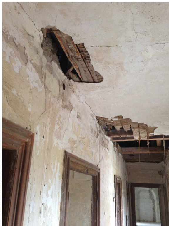
Obrázek 30 – odhalená stropní konstrukce vlivem degradace podhledu
