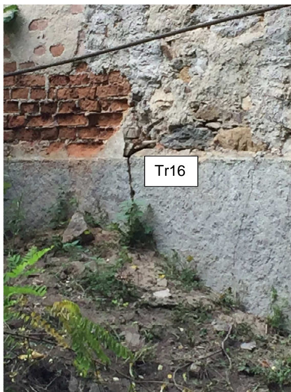
Obrázek 16 – trhlina v soklu jihovýchodní věže
