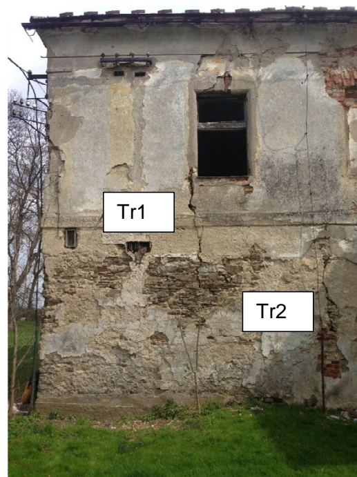
Obrázek 14 - tahové trhliny na jihozápadním průčelí středního křídla
