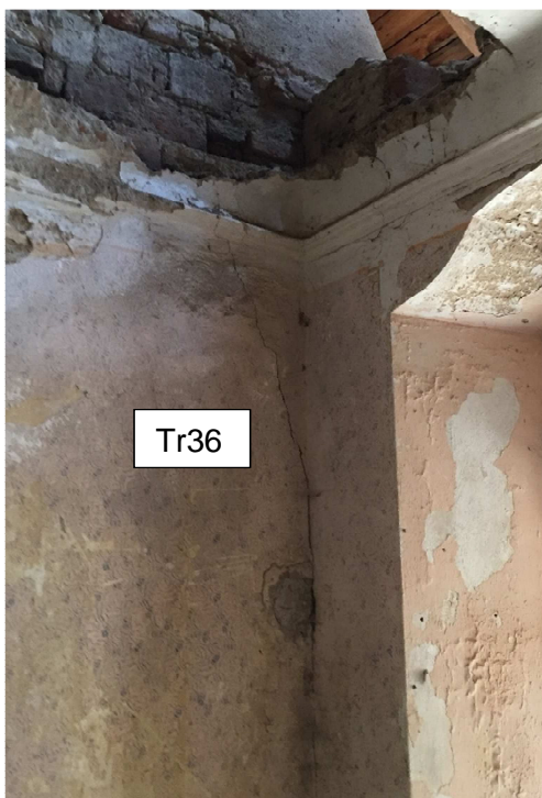
Obrázek 22 – trhlina na styku dvou stěn
