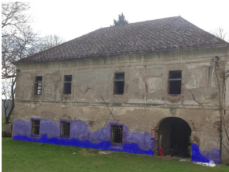
Obrázek 12 - vyznačené stopy vlhkosti na severozápadním průčelí objektu
