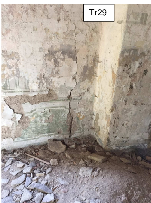
Obrázek 20 – trhlina na obvodové stěně v jihozápadní věži
