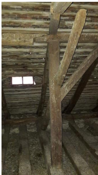
20. Stav suchého krovu, rozpojení prvku krovu
