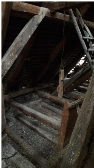
25 Narušení vazného trámu dřevokazným hmyzem
