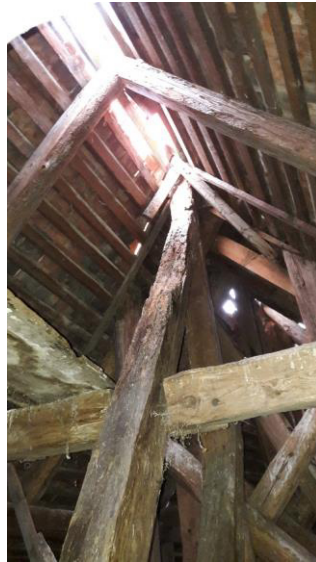
23 Porušení vzpěry věže zvonice
