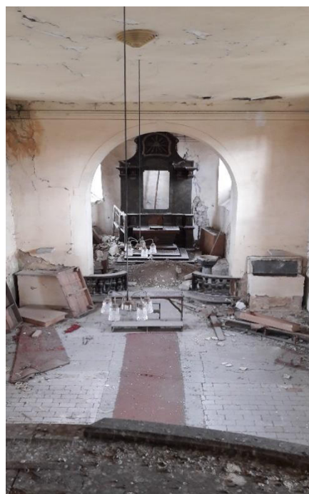
36. Poškozený strop vlivem degradace stropních prvků
