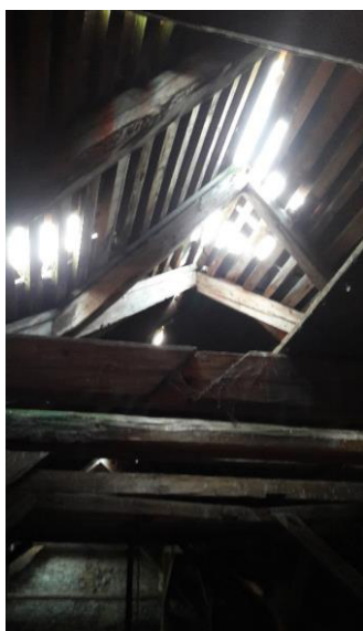
19. Chybějící střešní krytina
