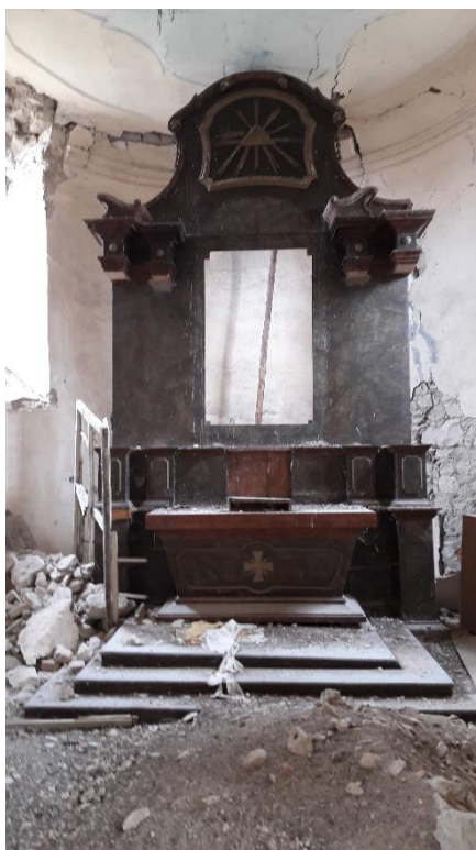
9. Za oltářem prasklina v místě opěráku III. Nad oltářem u stropu horizontální trhlinka
