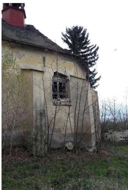
12. Spadlé nadpraží jižního okna
