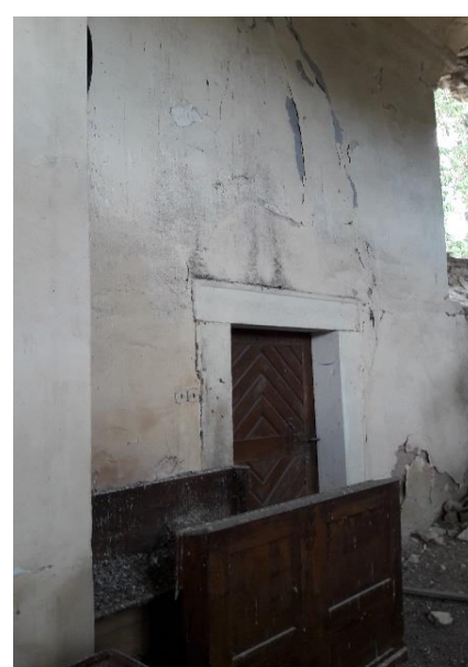
7. Tlakové porušení severní stěny přilehlé k oltáři
