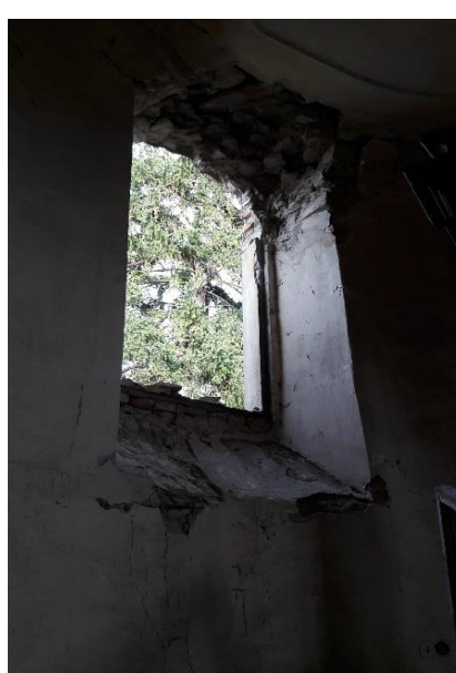
11. Spadlé nadpraží severního okna
