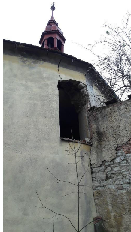
10. Spadlé nadpraží severního okna a prasklina definující zlom konstrukce
